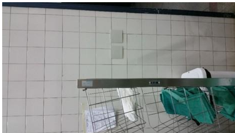
Figura 4 - Paredes íntegras, mas de difícil limpeza. Centro de Material e Esterilização do Hospital Geral de Palmas. Palmas-TO, 2017.
