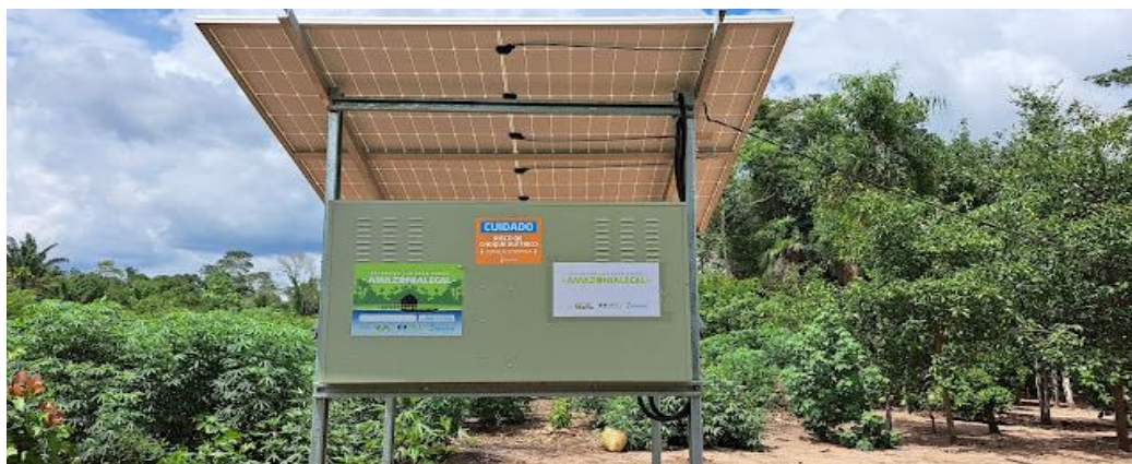
Figura 44 - Painel solar instalado no território Apinayé.
