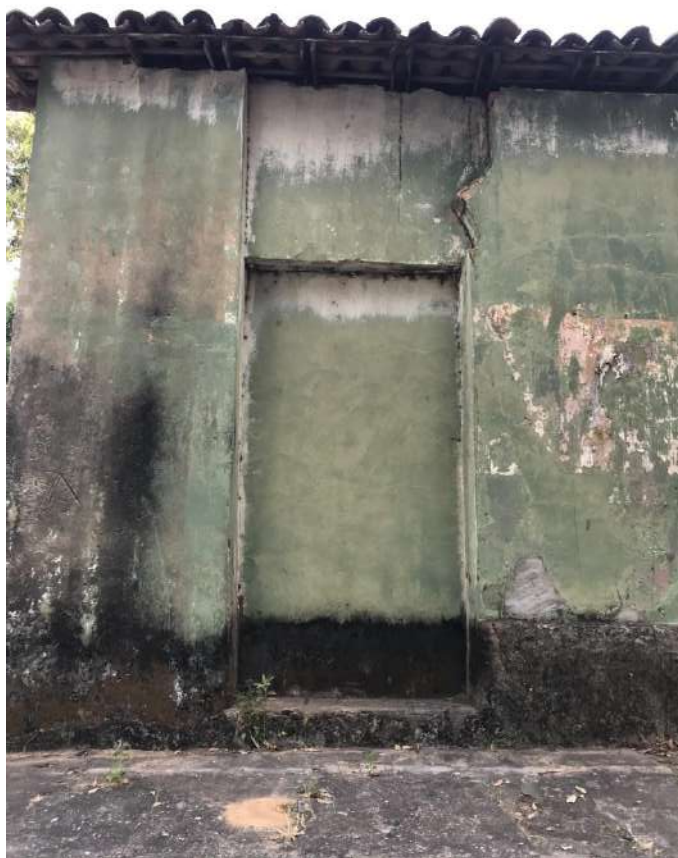
Figura 77 — Elemento ausente na fachada norte.
