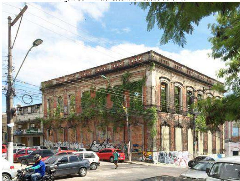
Figura 38 — Hotel Cassina em estado de ruína.
