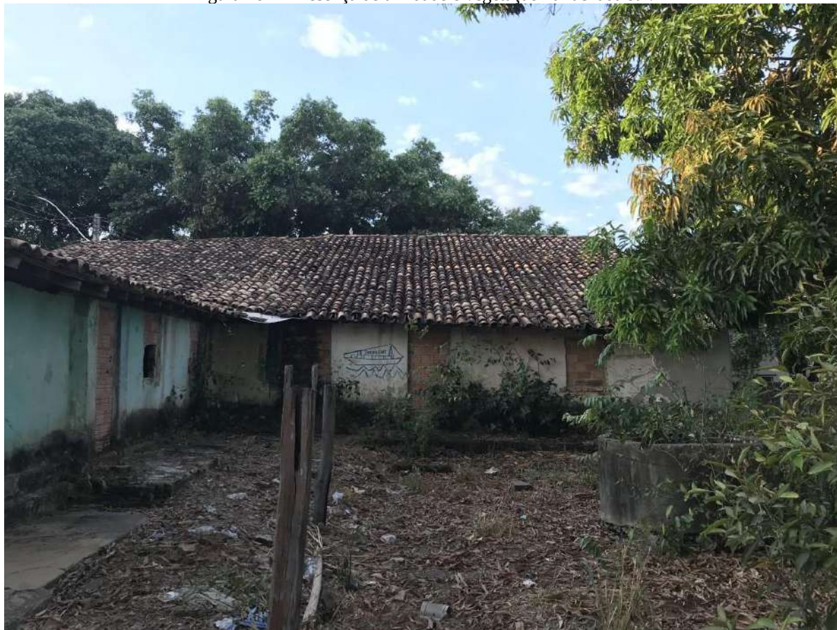
Figura 76 — Presença de umidade e vegetação na fachada sul.
