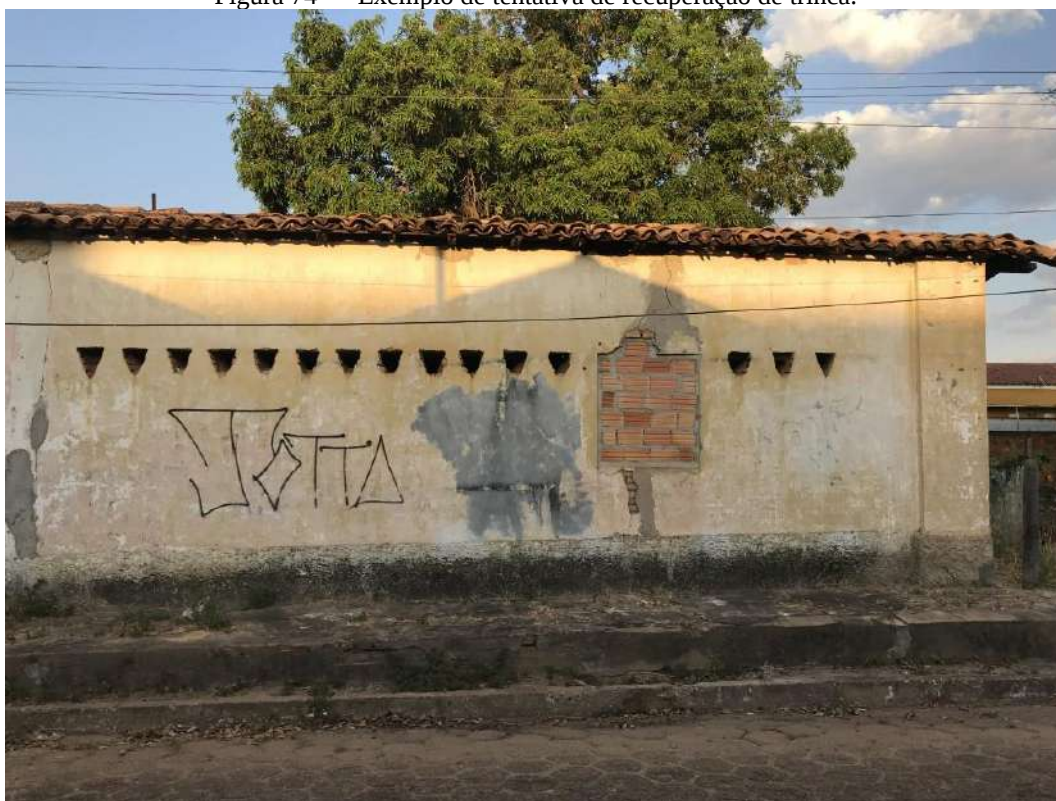
Figura 74 — Exemplo de tentativa de recuperação de trinca.
