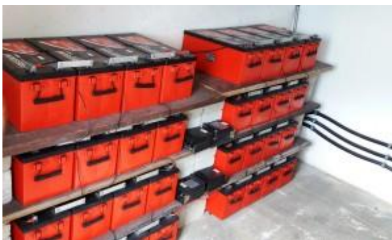
Figura 3.3 Banco de Baterias.
