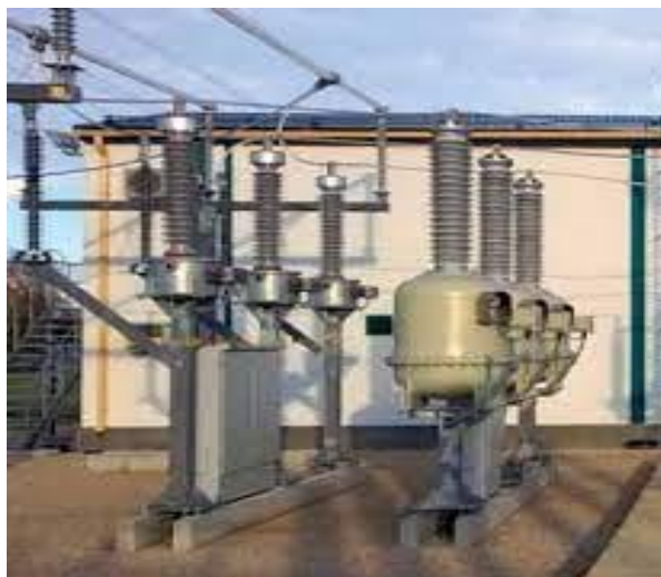
Figura 3.1 Transformador de Serviço Auxiliar .
