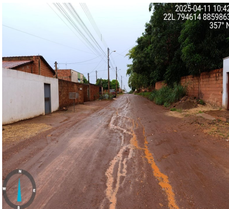
Figura 13: Ausência de pavimentação asfáltica e de calçadas no Setor Irmã Dulce.
