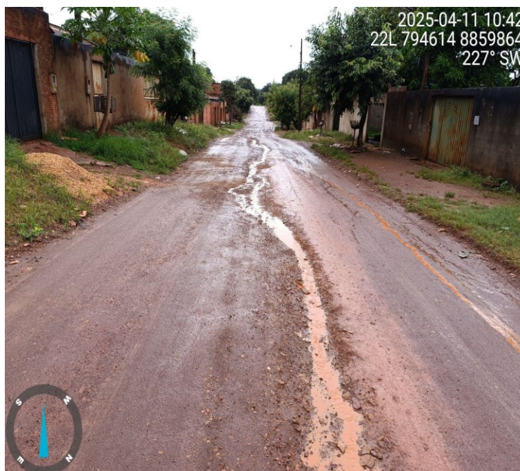
Figura 10: Processos erosivos de escoamento superficial da água das pluviais.
