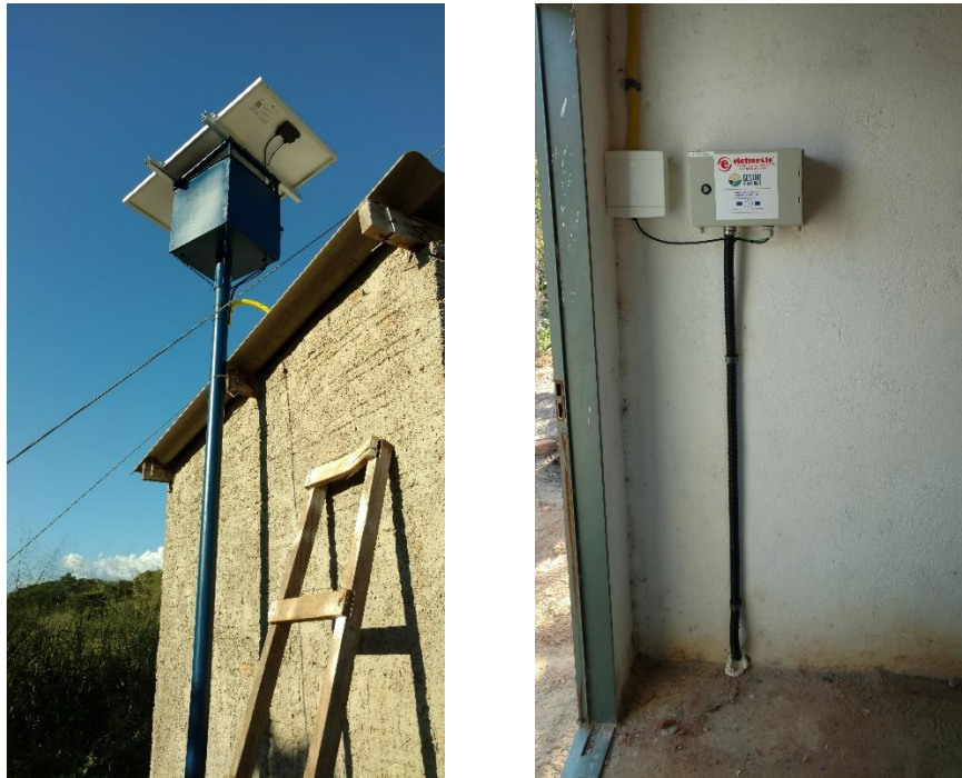
Figura 23. Fotografias da alimentação solar do sistema de monitoramento.
