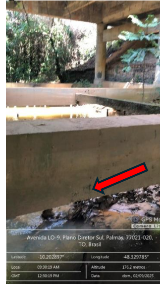
Figura 51 - Falha de concretagem em viga de travamento ao Oeste
