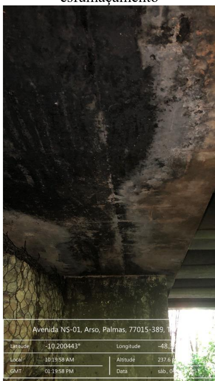
Figura 303 - Manchas de chama e esfumaçamento
