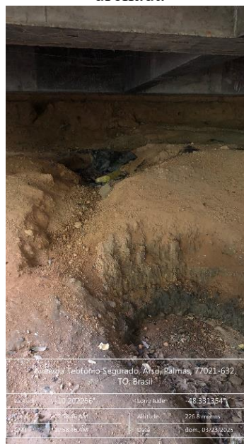
Figura 180 - Erosão por ação da água drenada
