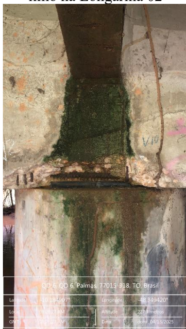
Figura 254 - Corrosão e formação de limo na Longarina 02
