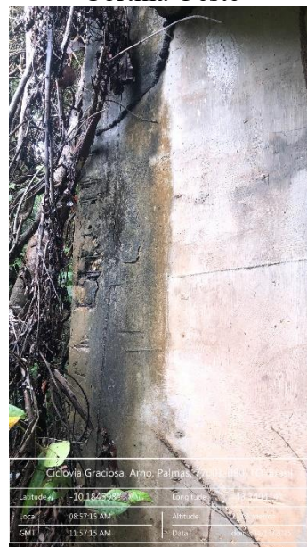
Figura 251 - Umidade, Corrosão e falha de concretagem na extremidade Sul da Cortina Oeste
