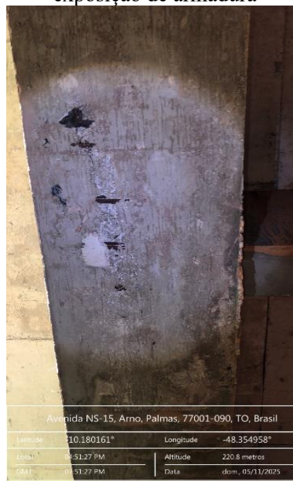
Figura 413 - Falhas de concretagem com exposição de armadura
