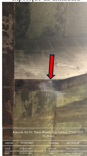
Figura 71 - Mancha de umidade e exposição da armadura
