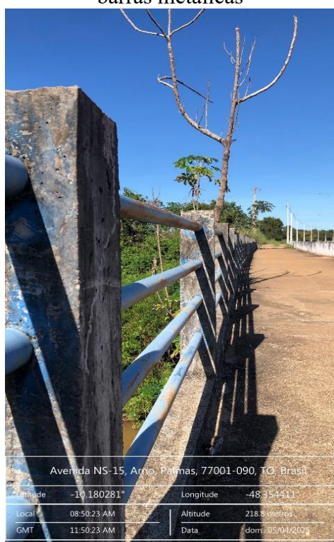
Figura 371 - Corrosão superficial nas barras metálicas
