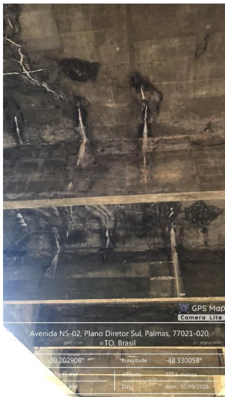
Figura 32 – Manchas nas transversinas
