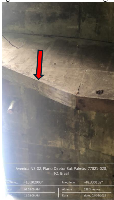
Figura 70- Falha de concretagem
