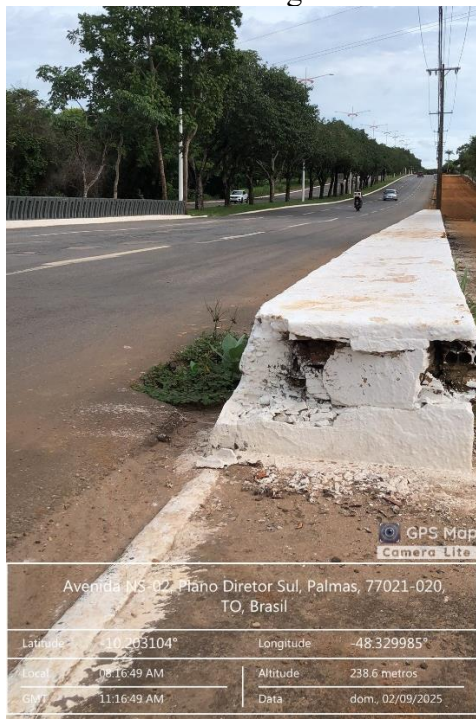
Figura 19 - Falta de transição na Barreira Rígida
