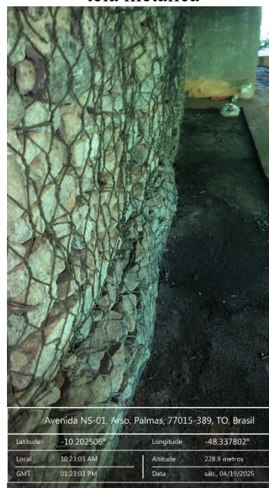
Figura 277 - Deformação excessiva na tela metálica
