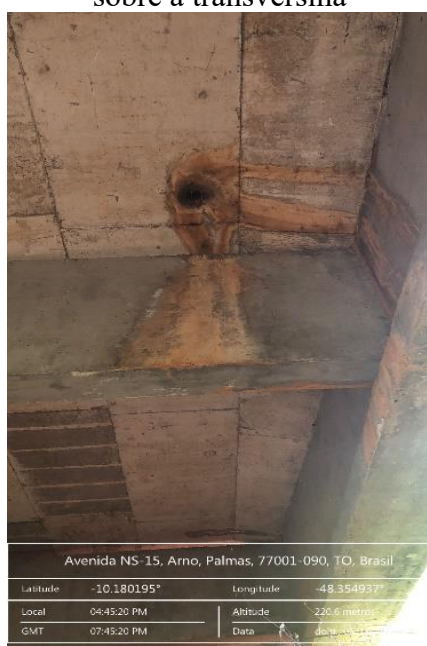
Figura 415 - Escoamento superficial sobre a transversina
