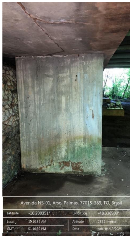
Figura 311 - Umidade na base do Pilar 07
