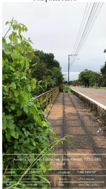
Figura 224 - Manchas de umidade no calçamento
