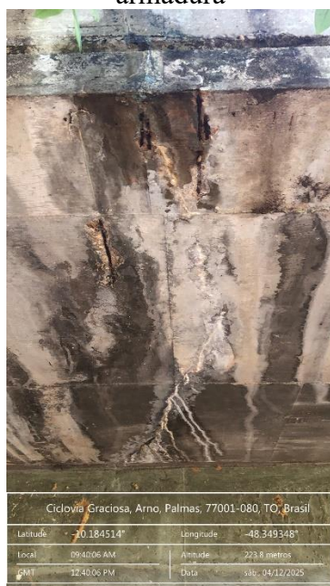
Figura 202 - Eflorescência e corrosão de armadura
