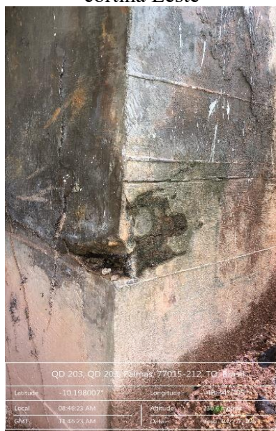
Figura 345 - Exposição de armadura na cortina Leste
