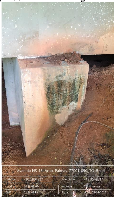
Figura 381 - Umidade na viga travessa 01
