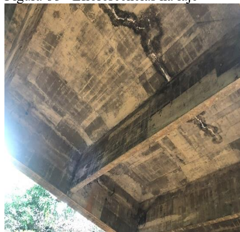
Figura 66 - Eflorescências na laje
