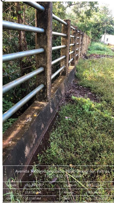
Figura 101 - Manchas de umidade
