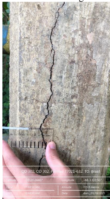
Figura 105 - Fissura no guarda-corpo
