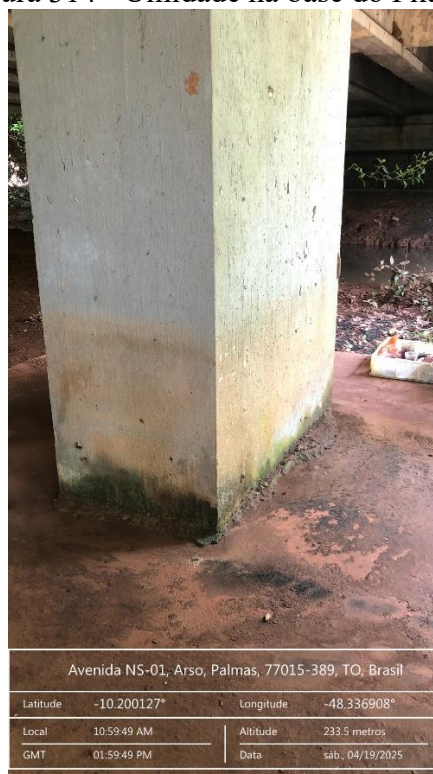
Figura 314 - Umidade na base do Pilar 04
