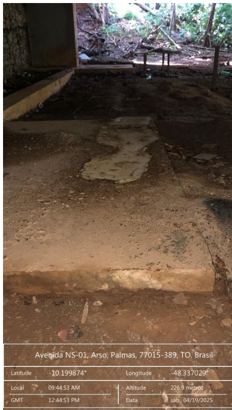
Figura 317 - Umidade e eflorescência no Bloco 02
