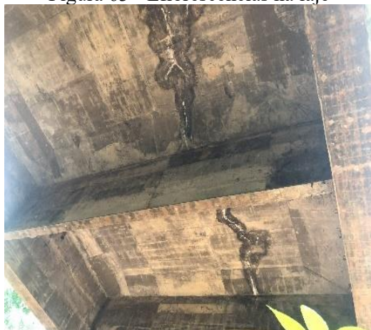
Figura 63 - Eflorescências na laje
