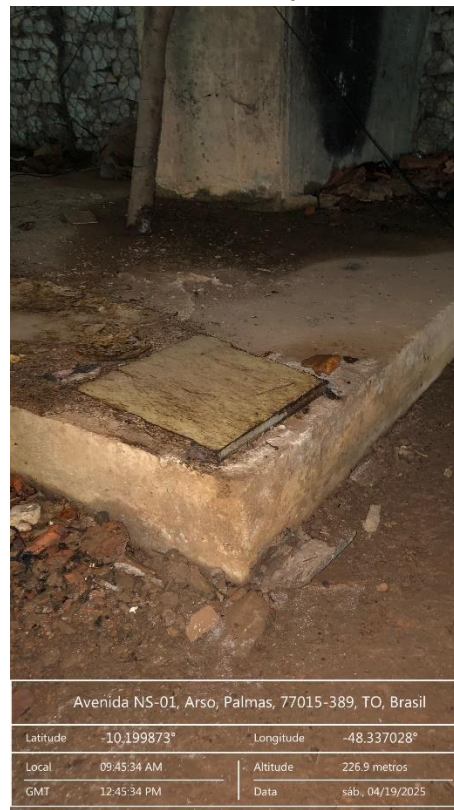
Figura 318 - Umidade e eflorescência no Bloco 02
