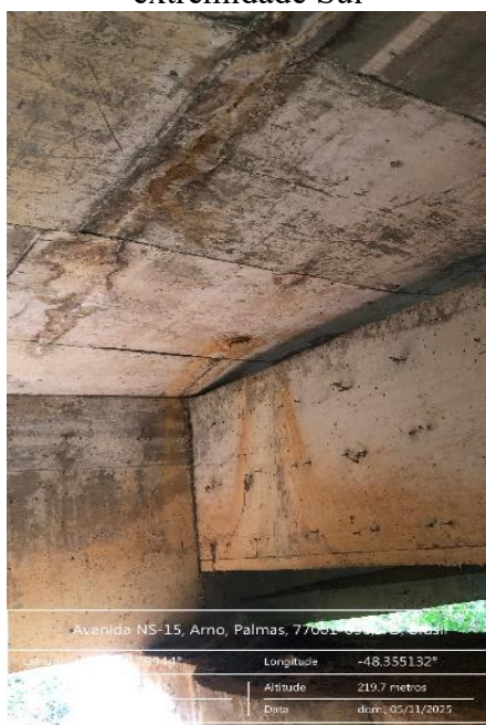
Figura 406 - Manchas de eflorescência na extremidade Sul
