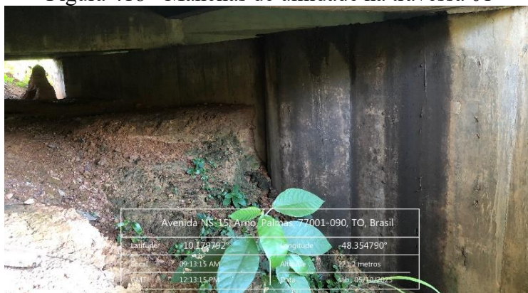
Figura 418 - Manchas de umidade na travessa 01
