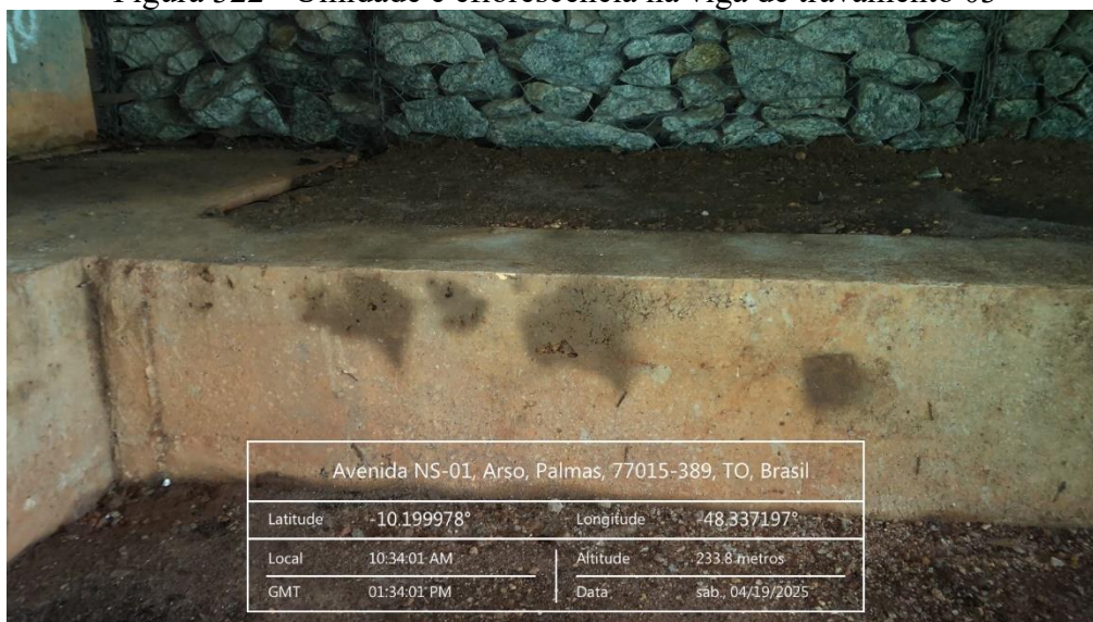
Figura 322 - Umidade e eflorescência na viga de travamento 03
