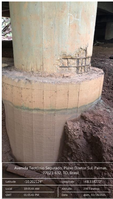
Figura 136 - Erosão em torno do Bloco 04
