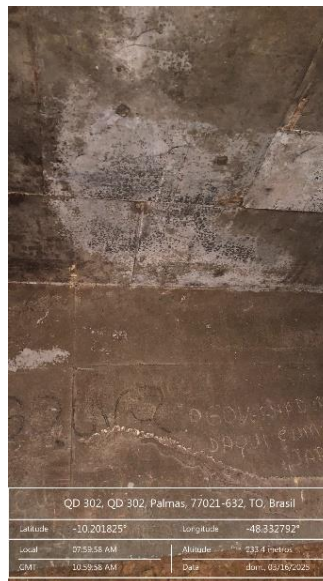
Figura 114 - Manchas de eflorescência
