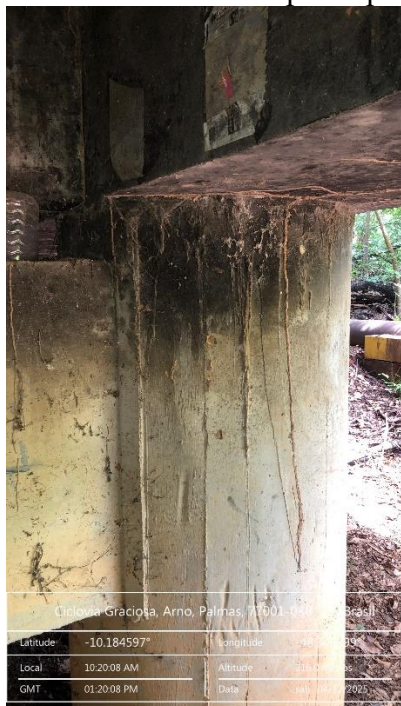
Figura 214 - Mancha no topo do pilar 04
