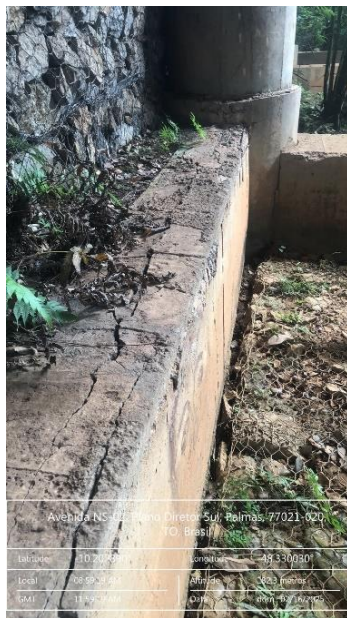
Figura 80 – Deslocamento de cobrimento
