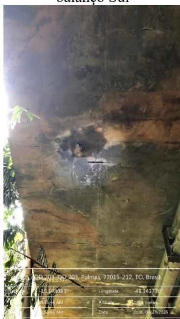
Figura 335 - Umidade e corrosão no balanço Sul
