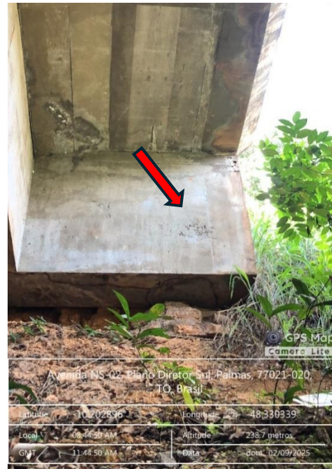
Figura 29 - Falha de concretagem na Cortina Sul
