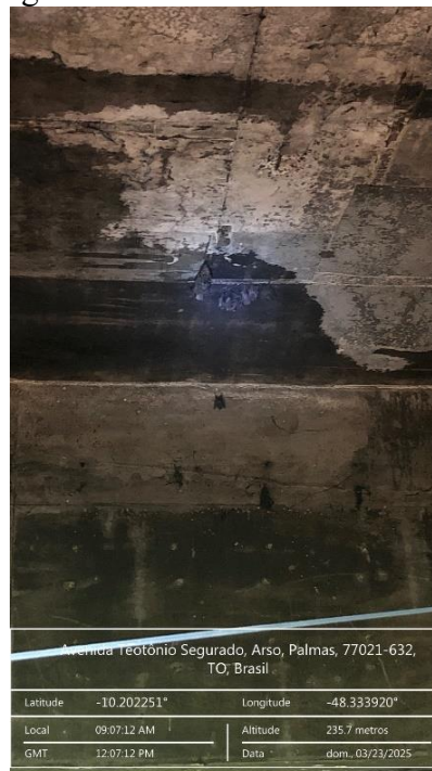
Figura 158 - Eflorescência na laje
