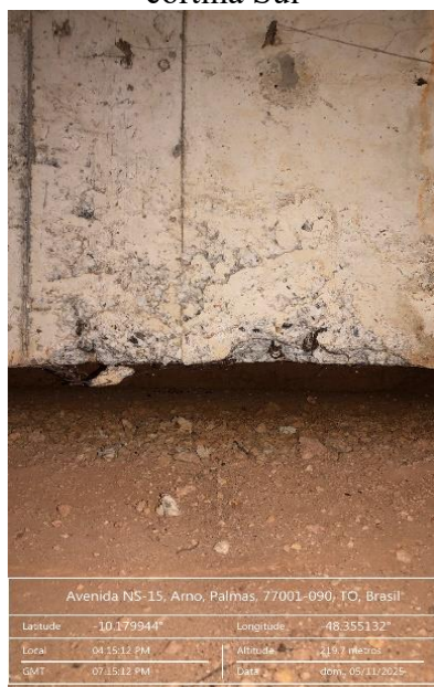
Figura 396 - Falha de concretagem na cortina Sul
