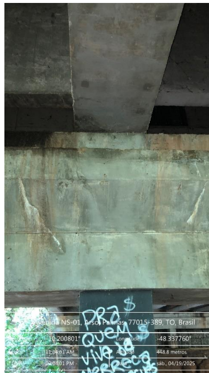
Figura 296 - Manchas de umidade e eflorescência
