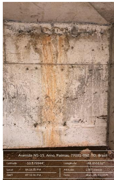
Figura 400 - Percolação de água através de falhas na cortina Sul
