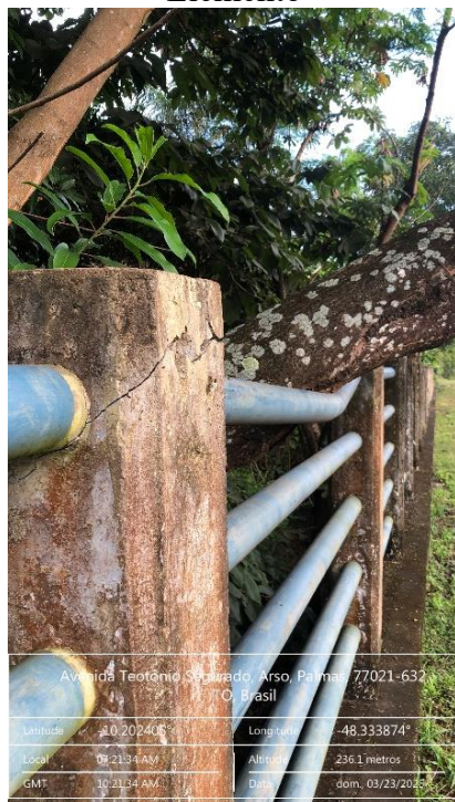
Figura 143 – Rachadura no Topo do Elemento
