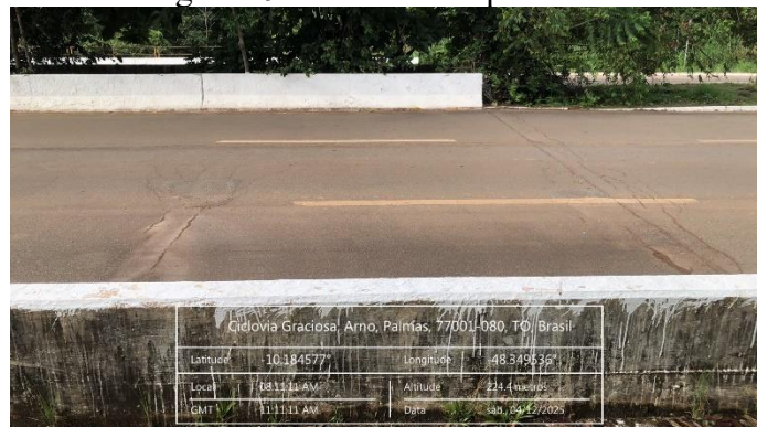
Figura 191 - Trincas no pavimento
