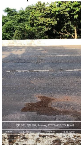
Figura 109 - Irregularidades no pavimento
