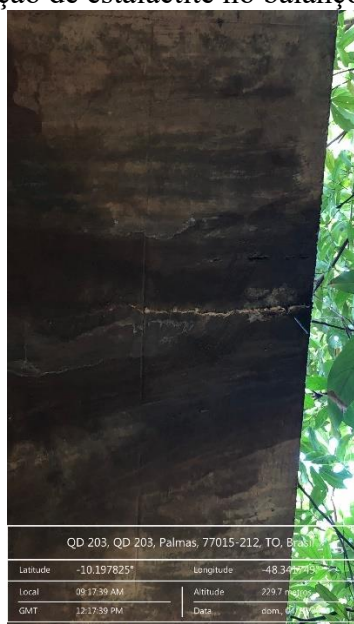
Figura 341 - Eflorescência com pequena formação de estalactite no balanço Norte
