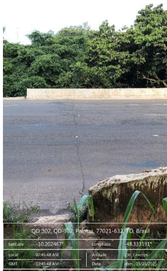
Figura 108 - Trincas no pavimento
