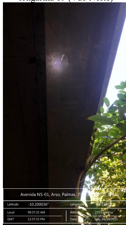
Figura 283 - Sinal de eflorescência na longarina 09 (Vão Norte)
