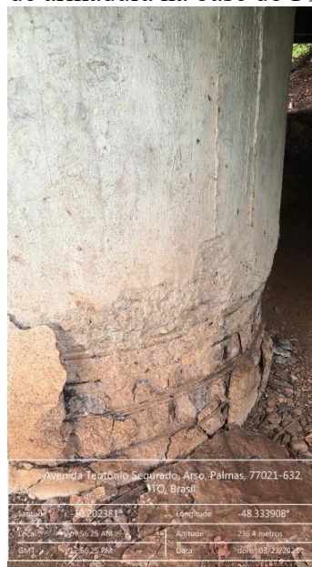
Figura 178 - Deslocamento e exposição de armadura na base do P9
