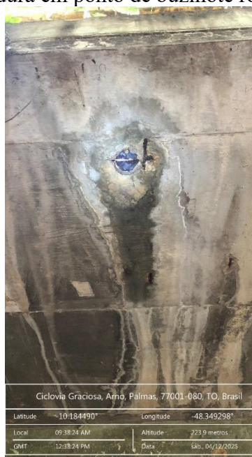
Figura 201 - Eflorescência e corrosão de armadura em ponto de buzinode rompido
