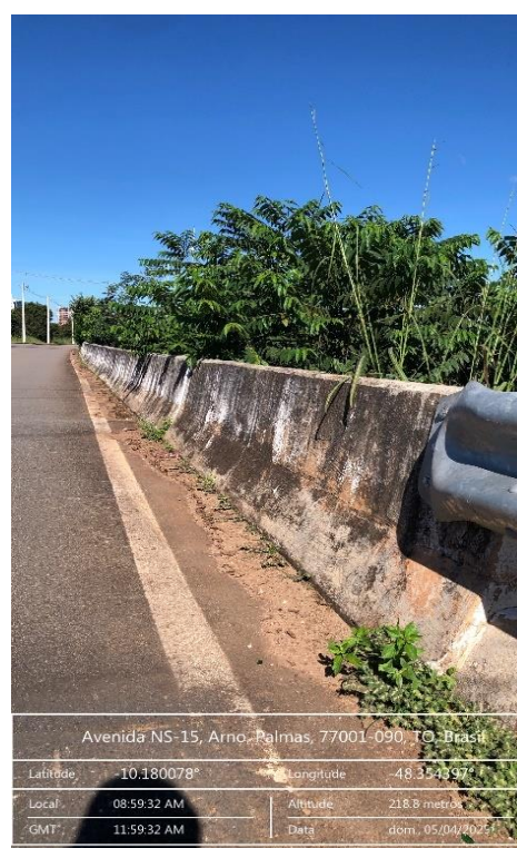
Figura 372 - Leve degradação superficial
