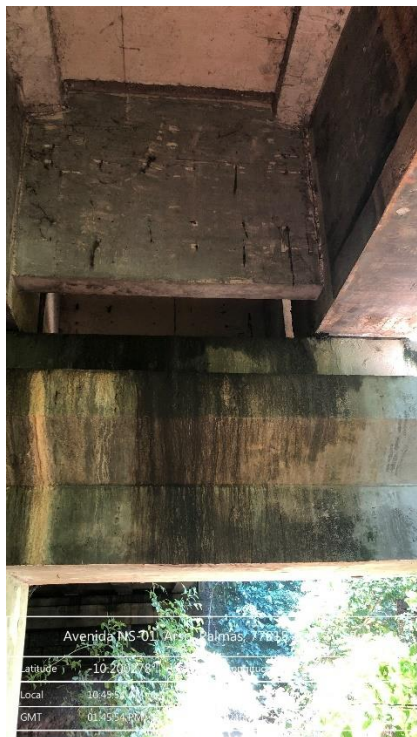
Figura 291 - Mancha de umidade na extremidade Leste
