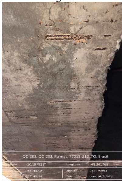
Figura 352 - Insuficiência de cobrimento na longarina 02
