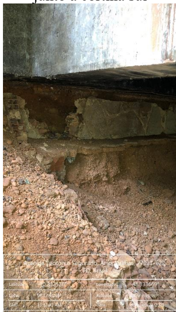
Figura 183 – Fuga do material de aterro junto à cortina sul
