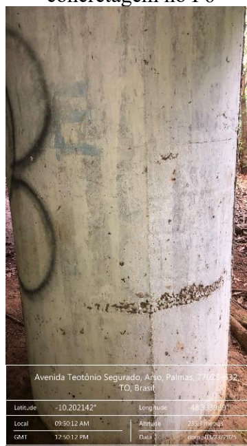
Figura 172 – Pequena falha de concretagem no P6
