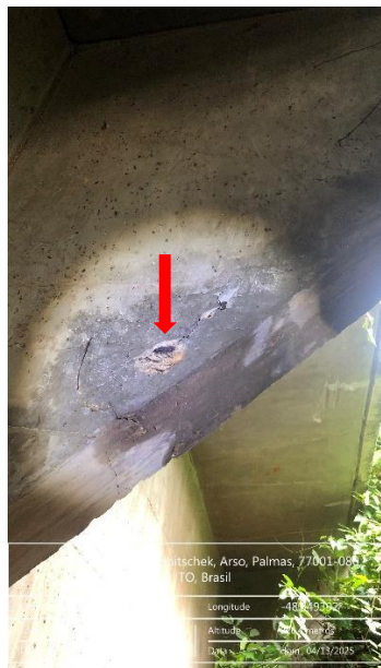
Figura 256 - Deslocamento e exposição de armadura em transversina
