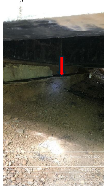
Figura 184 - Fuga do material de aterro junto à cortina sul
