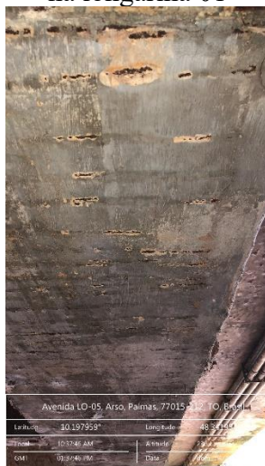
Figura 350 - Insuficiência de cobrimento na longarina 01
