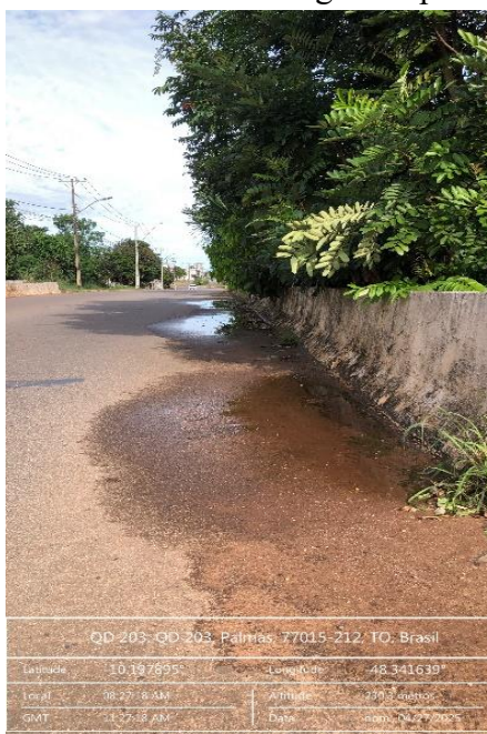
Figura 331 - Acúmulo de água no pavimento
