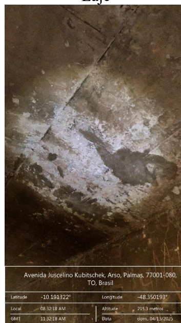
Figura 245 - Manchas de eflorescência na Laje
