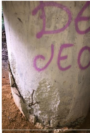
Figura 164 – Deslocamento e exposição de armadura na base do P1
