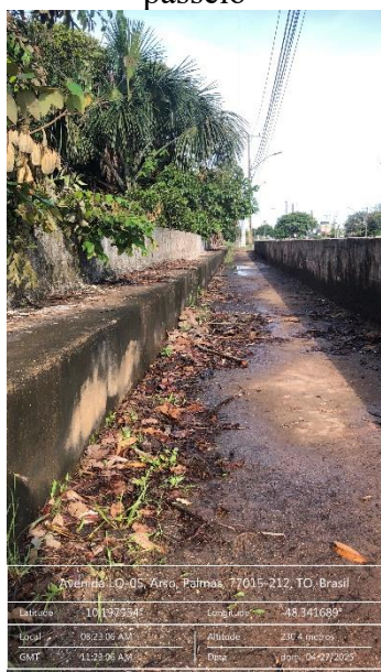
Figura 328 - Acúmulo de sedimentos no passeio
