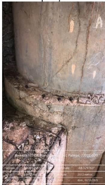
Figura 89 - Exposição de Armadura
