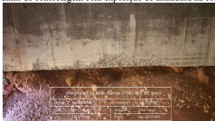
Figura 393 - Falhas de concretagem com exposição de armadura na cortina Norte
