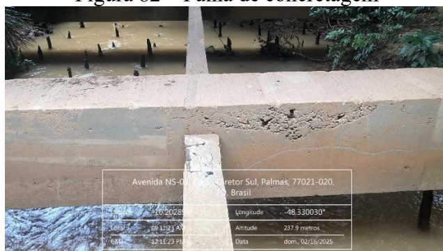
Figura 82 – Falha de concretagem
