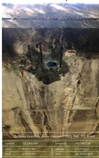
Figura 199 - Eflorescência, limo e corrosão de armadura em ponto de buzino rompido
