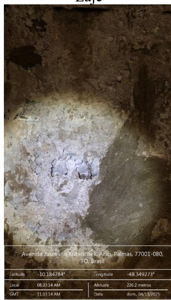
Figura 246 - Falha de concretagem na Laje
