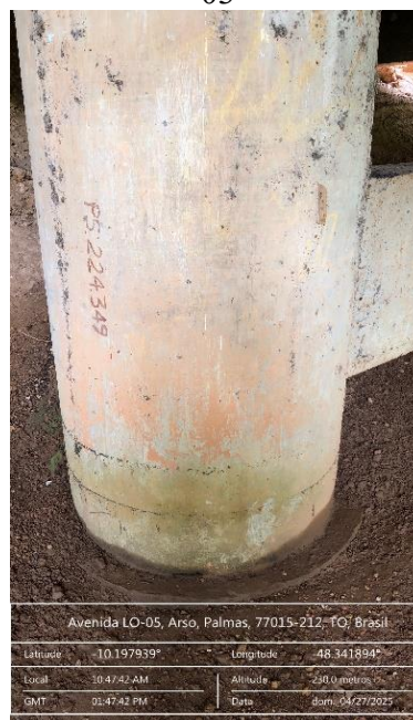
Figura 357 - Indícios de umidade no pilar 03
