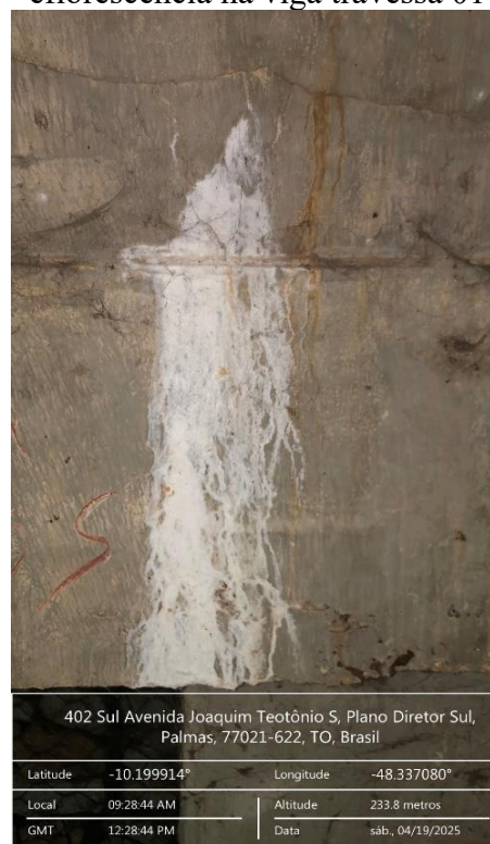
Figura 288 - Mancha característica de eflorescência na viga travessa 01
