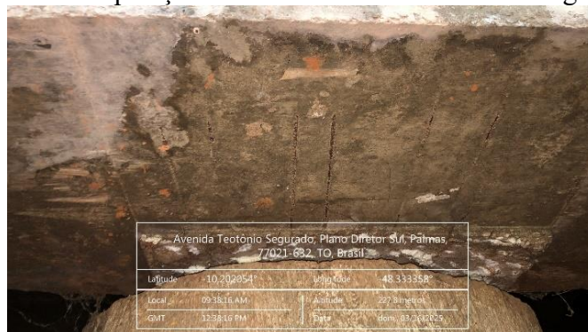
Figura 119 - Exposição de armadura e manchas na Longarina 01
