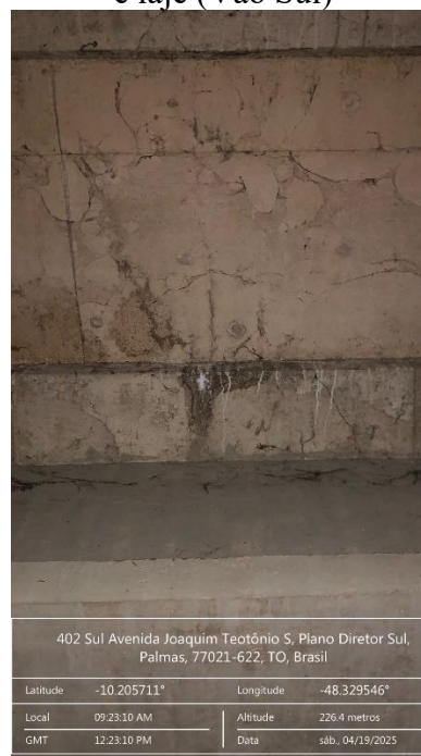
Figura 275 - Eflorescência entre viga 04 e laje (Vão Sul)
