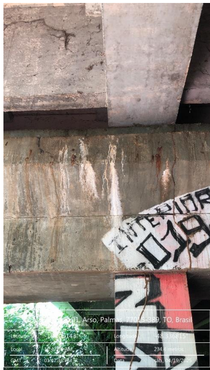
Figura 295 - Manchas de umidade e eflorescência
