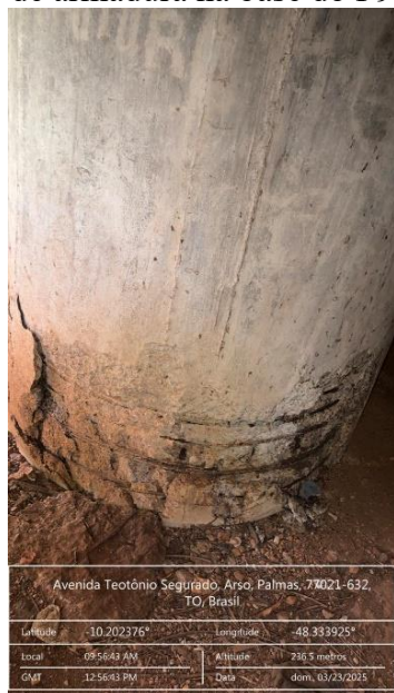
Figura 177 - Deslocamento e exposição de armadura na base do P9
