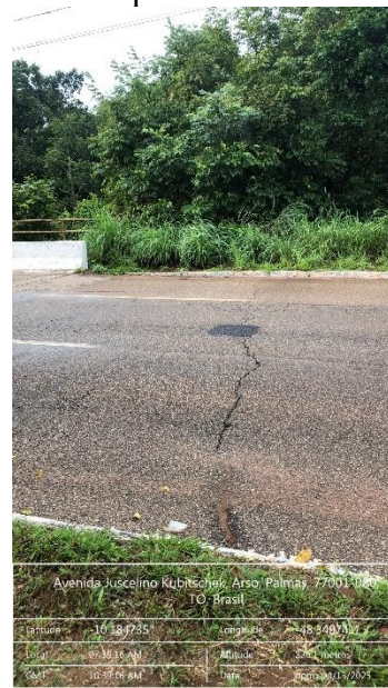
Figura 236 - Trinca contínua no pavimento
