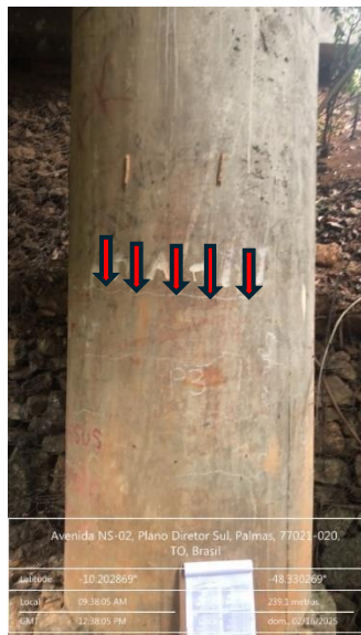
Figura 85 - Fissuras horizontais marcadas em branco
