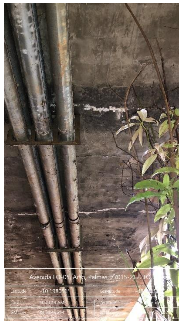
Figura 338 - Eflorescência no balanço Sul
