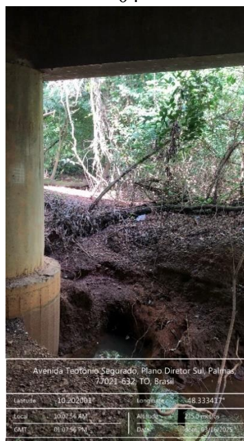
Figura 135 - Erosão em torno do Bloco 04
