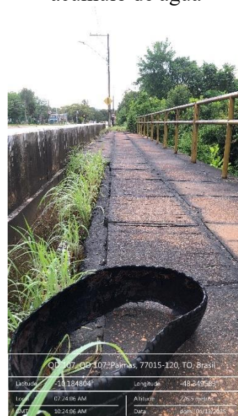
Figura 227 - Ausência de placas e acúmulo de água
