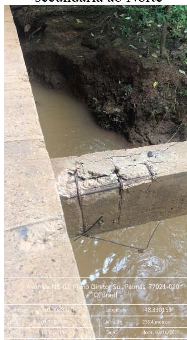
Figura 55 - Corrosão e rompimento de armadura de viga de travamento secundária ao Norte
