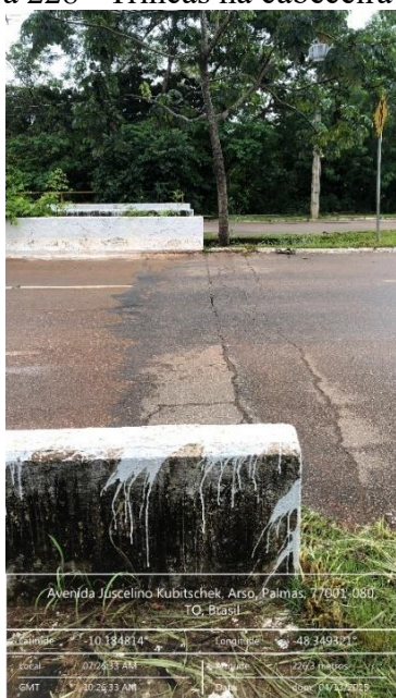
Figura 228 - Trincas na cabeceira Leste
