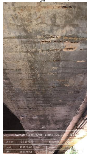
Figura 351 - Insuficiência de cobrimento na longarina 01
