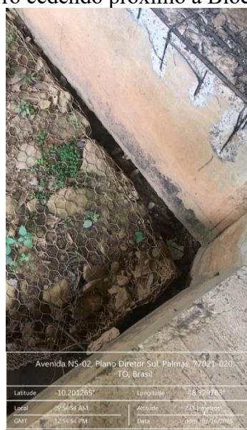
Figura 95 - Aterro cedendo próximo a Bloco de coroamento
