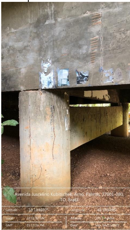
Figura 221 - Impossibilidade de inspecionar infraestrutura
