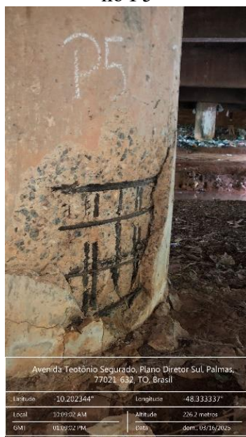
Figura 126 – Deslocamento e corrosão no P5
