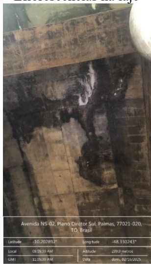
Figura 65 - Eflorescências na laje
