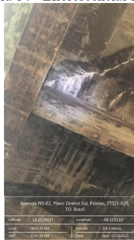
Figura 64 - Eflorescências na laje
