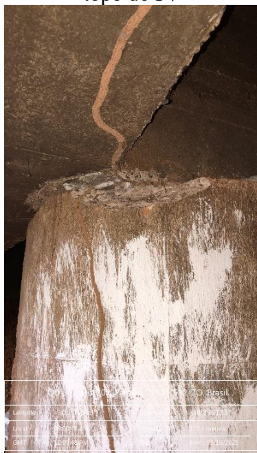
Figura 130 – Rompimento de concreto no topo do P7
