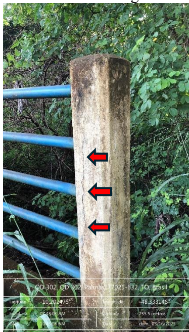
Figura 104 - Fissura no guarda-corpo
