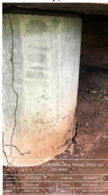
Figura 176 - Deslocamento na base do P9
