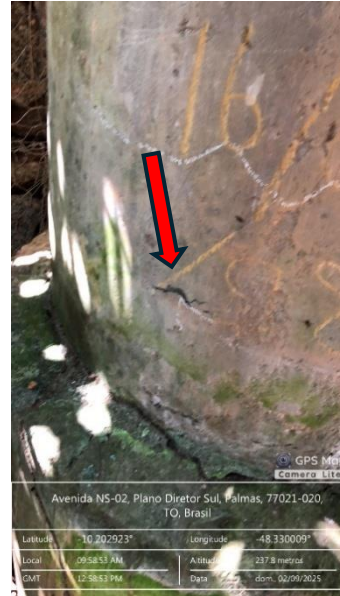
Figura 42 -Deslocamento na base do P2
