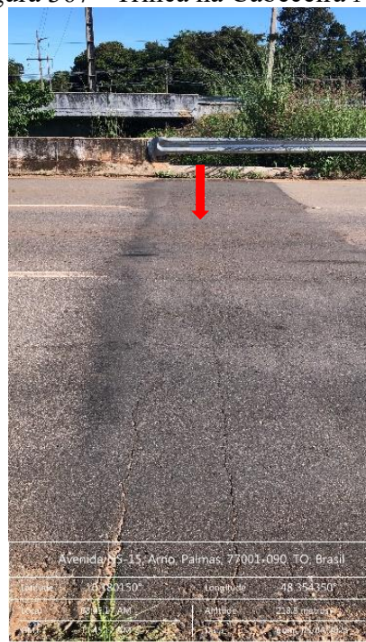
Figura 367 - Trinca na Cabeceira Norte
