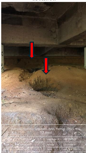
Figura 179 – Erosão por ação da água drenada
