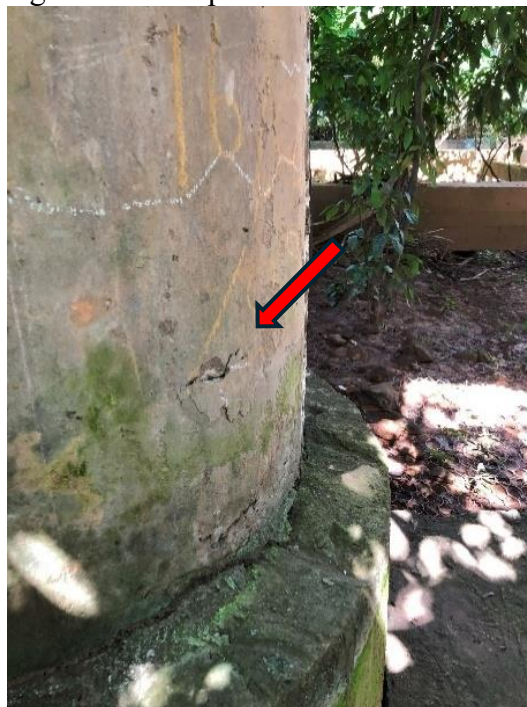
Figura 45 – Desplacimento na base do P1
