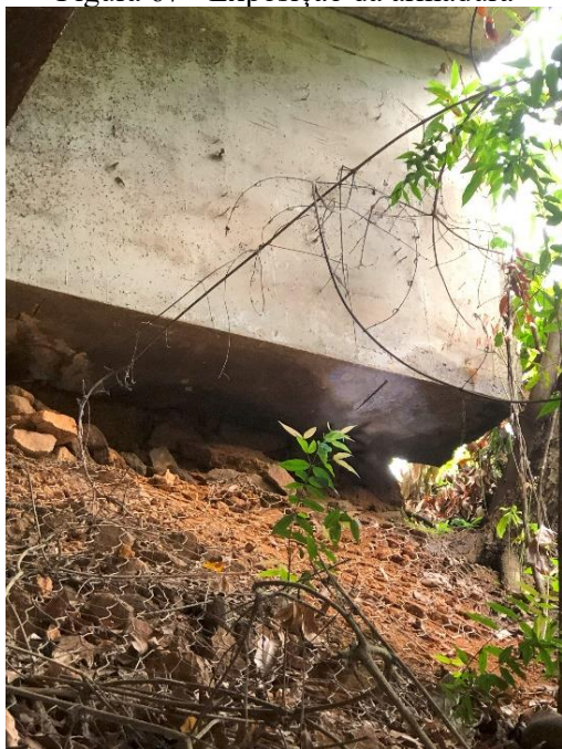
Figura 67 - Exposição da armadura
