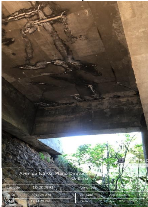
Figura 28 - Eflorescência no primeiro vão da Laje
