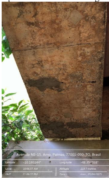
Figura 377 - Falha de concretagem e exposição de armadura na Longarina 01
