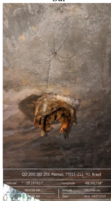
Figura 336 - Eflorescência no balanço Sul
