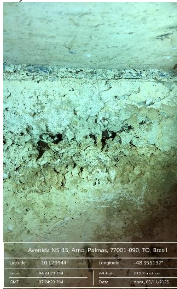
Figura 402 - Falha de concretagem e exposição de armadura na cortina Sul
