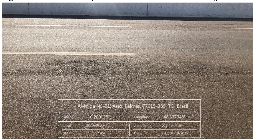
Figura 274 - Trincas em ponto intermediário do tabuleiro (pista Leste)
