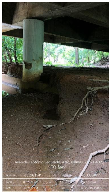
Figura 185 – Erosão próxima à margem sul
