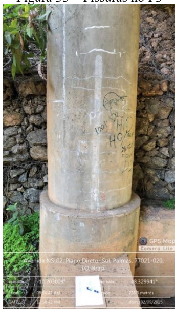
Figura 35 – Fissuras no P3
