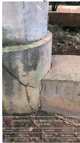
Figura 90 - Umidade no bloco e abertura de fenda com a viga de travamento
