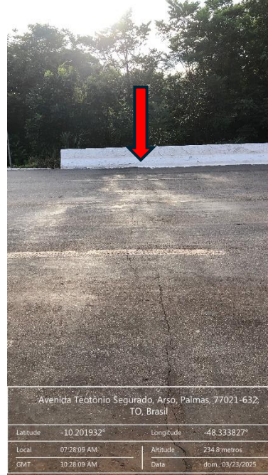
Figura 146 - Trinca e desnível na pista
