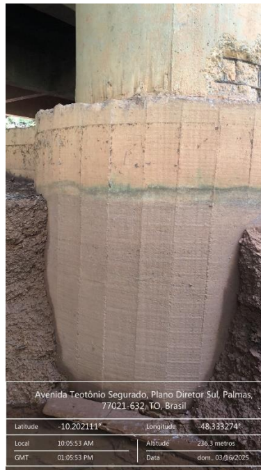
Figura 137 - Erosão em torno do Bloco 04
