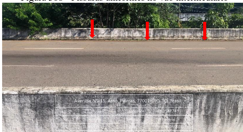
Figura 368 - Fissuras uniformes no vão intermediário
