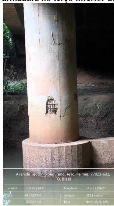
Figura 168 - Deslocamento e exposição de armadura no terço inferior do P4
