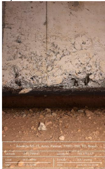
Figura 401 - Falha de concretagem e exposição de armadura na cortina Sul
