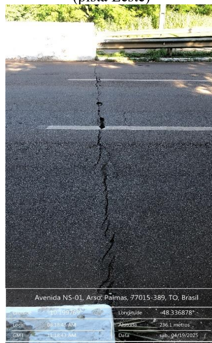
Figura 271 - Trinca na cabeceira Norte (pista Leste)
