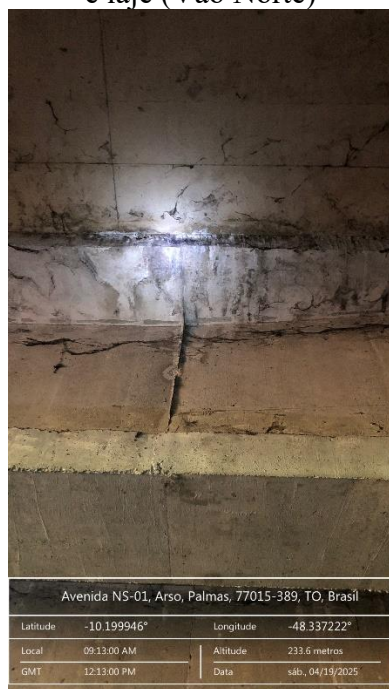
Figura 274 - Eflorescência entre viga 05 e laje (Vão Norte)
