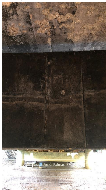
Figura 220 - Manchas na transversina 04
