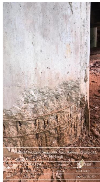
Figura 174 - Deslocamento e exposição de armadura na base do P7
