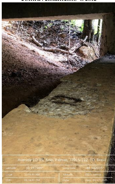
Figura 354 - Desplacamento na viga de contraentramento Oeste
