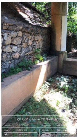
Figura 48 - Manchas de umidade em viga de travamento ao norte
