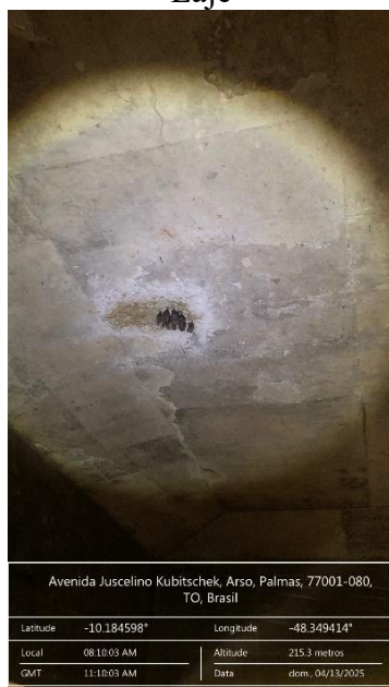
Figura 244 - Manchas de eflorescência na Laje
