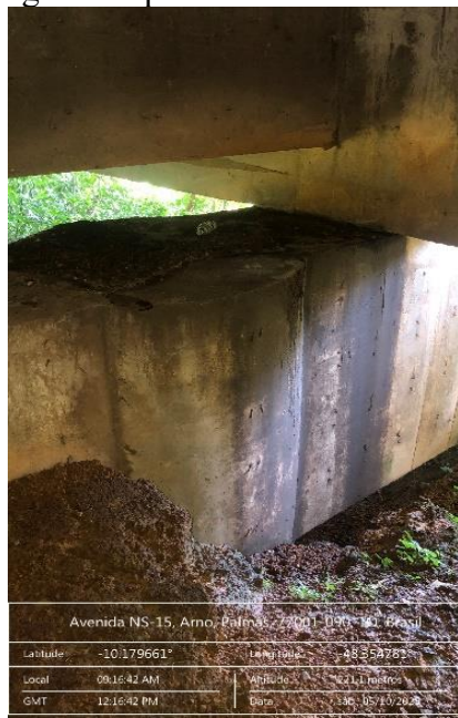
Figura 422 - Umidade proveniente de drenagem em pilar da extremidade Norte
