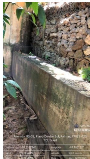
Figura 49 - Umidade na Viga de travamento ao sul
