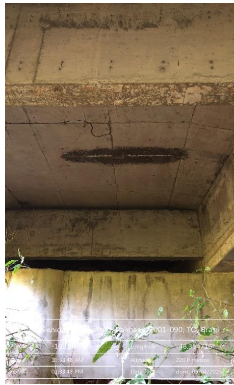
Figura 374- Eflorescência próxima à cabeceira Sul
