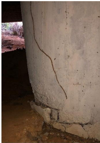
Figura 165 - Deslocamento e exposição de armadura na base do P2
