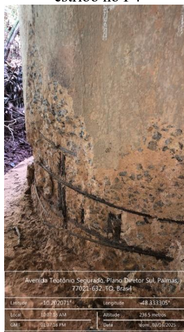
Figura 125 - Corrosão e rompimento de estribo no P4
