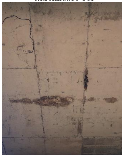
Figura 409 - Sinais de eflorescência na extremidade Sul
