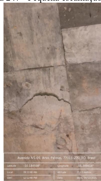
Figura 247 - Pequena escamação na laje
