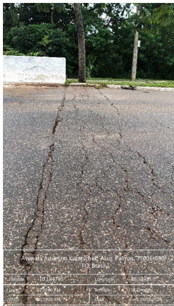
Figura 230 - Trincas na cabeceira Leste
