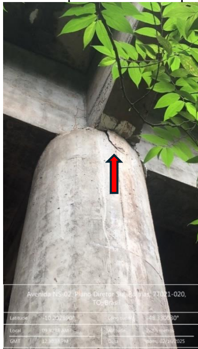
Figura 87 - Deslocamento no topo do P2
