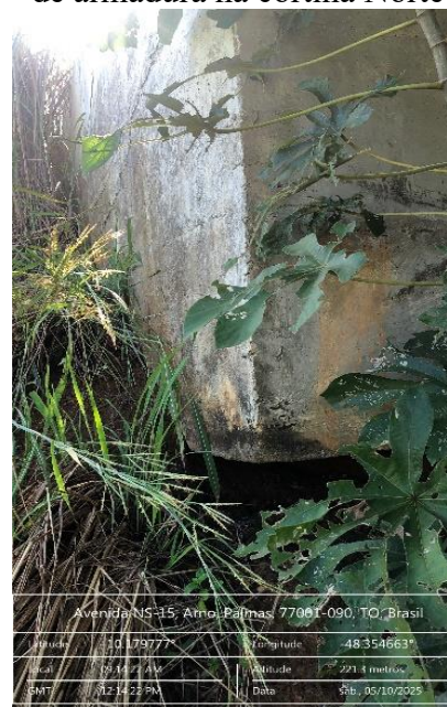
Figura 392 - Limo e indícios de corrosão de armadura na cortina Norte
