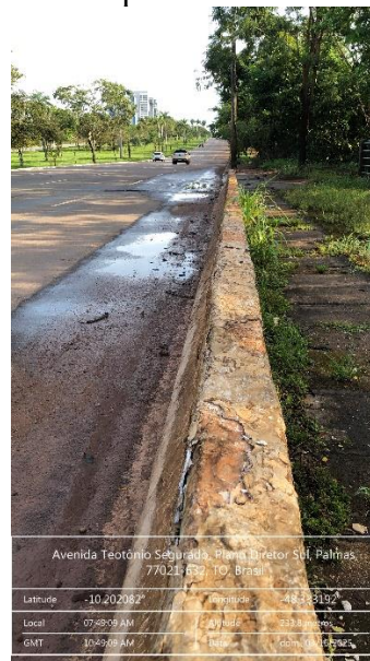
Figura 107 - Acúmulo de água no pavimento
