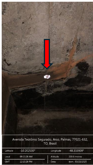
Figura 153 - Manchas de umidade
