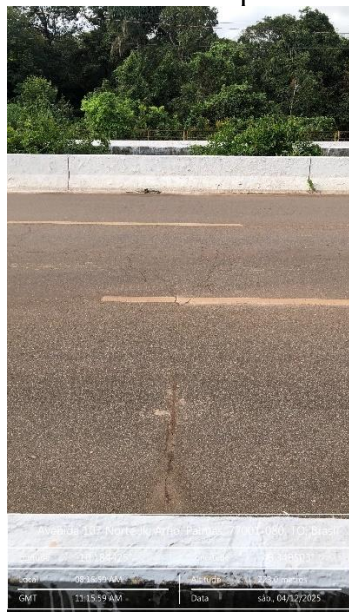
Figura 192 - Trincas no pavimento localizadas acima dos pilares Oeste
