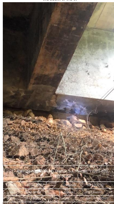
Figura 68 - Eflorescência e exposição da armadura
