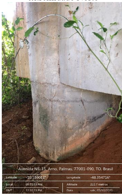
Figura 424 - Umidade em pilar da extremidade Norte
