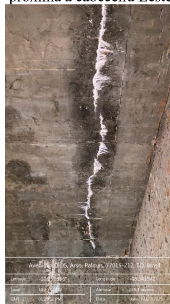
Figura 342 - Eflorescência transversal próxima à cabeceira Leste
