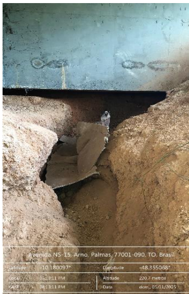
Figura 399 - Carreamento de solo abaixo da cortina Sul
