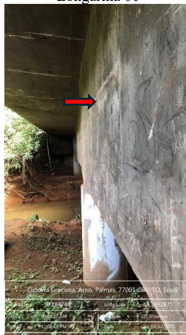
Figura 219 - Pequenas manchas na Longarina 01
