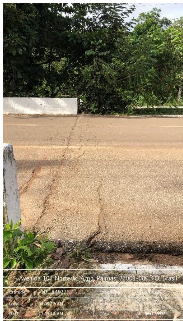
Figura 189 - Trincas na cabeceira Oeste
