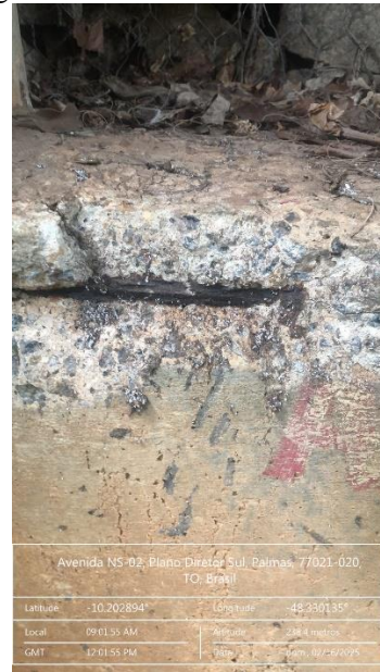
Figura 81 – Corrosão de armadura
