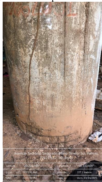
Figura 129 - Desplacamento no P7
