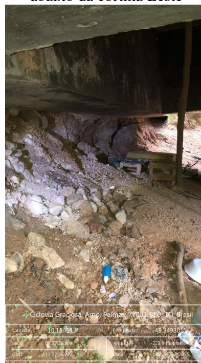
Figura 211 - Fuga do material de aterro abaixo da cortina Leste
