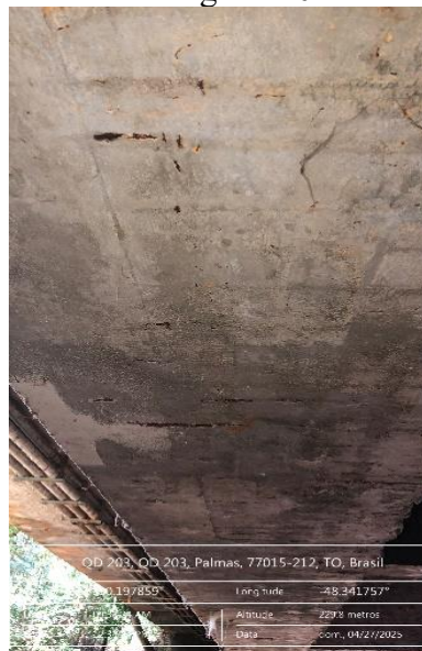
Figura 353 - Insuficiência de cobrimento na longarina 02
