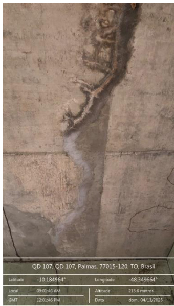
Figura 242 - Eflorescência na Laje
