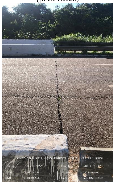
Figura 268 - Trinca na cabeceira Sul (pista Oeste)
