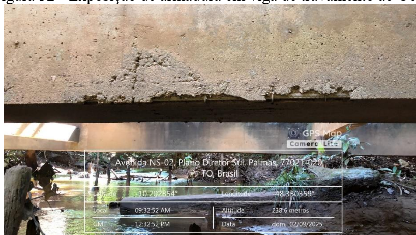
Figura 52 - Exposição de armadura em viga de travamento ao Oeste
