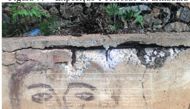
Figura 77 – Exposição e corrosão de armadura
