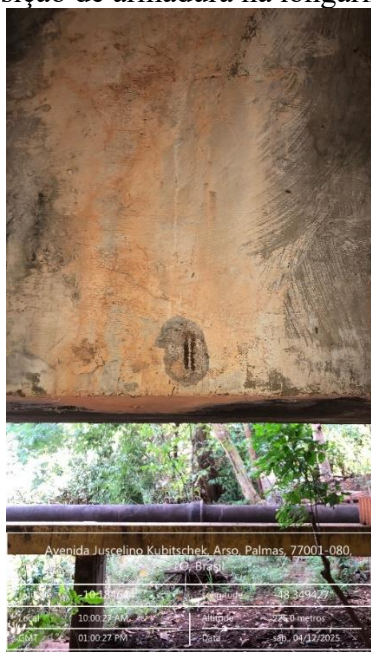
Figura 218 - Deslocamento com exposição de armadura na longarina 02
