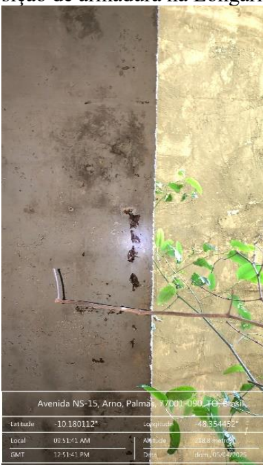
Figura 379 - Falha de concretagem e exposição de armadura na Longarina 03
