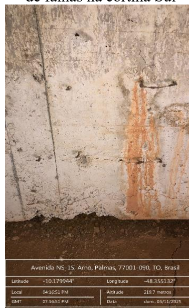
Figura 397 - Percolação de água através de falhas na cortina Sul
