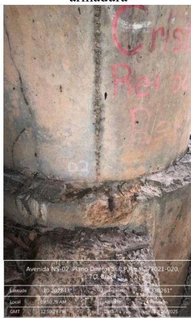
Figura 91 - Exposição e corrosão de armadura
