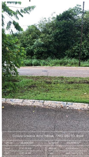
Figura 235 - Trinca contínua no pavimento
