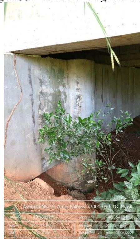
Figura 382 - Umidade na viga travessa 01
