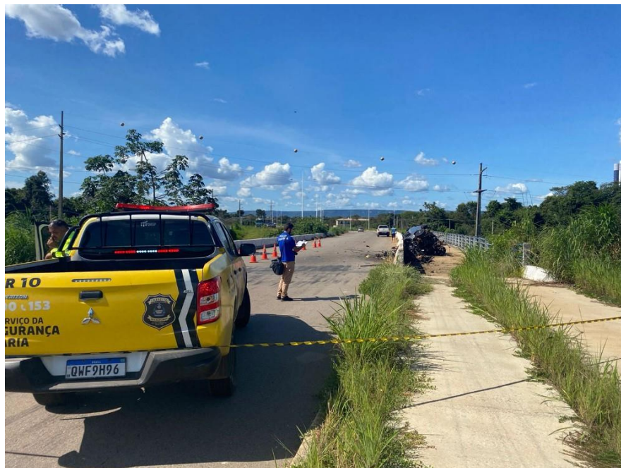
Figura 360 - Ausência de transição metálica na Barreira rígida em 2022
