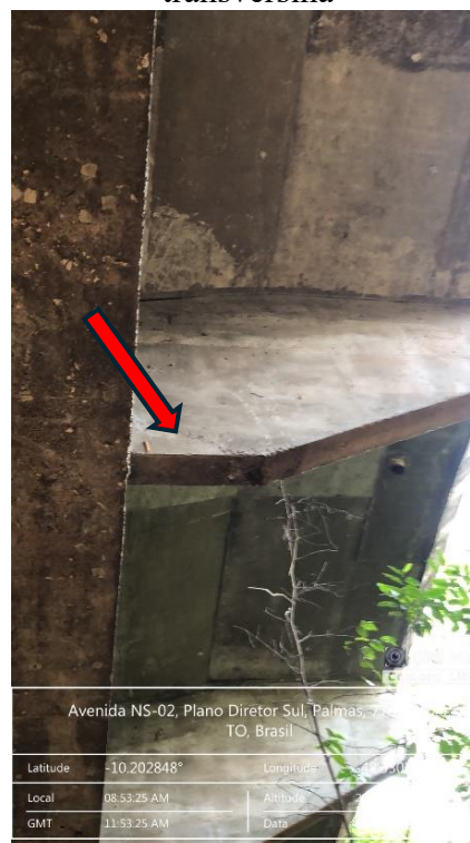
Figura 33 - Sinais de eflorescência na Longarina e exposição da armadura na transversina
