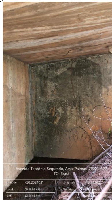
Figura 151 - Umidade na Cortina Sul
