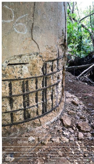
Figura 128 - Corrosão e rompimento de estribo no P6
