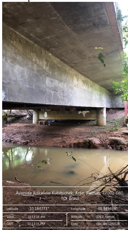
Figura 222 - Impossibilidade de inspecionar infraestrutura
