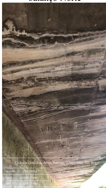
Figura 200 - Manchas de eflorescência no balanço Norte
