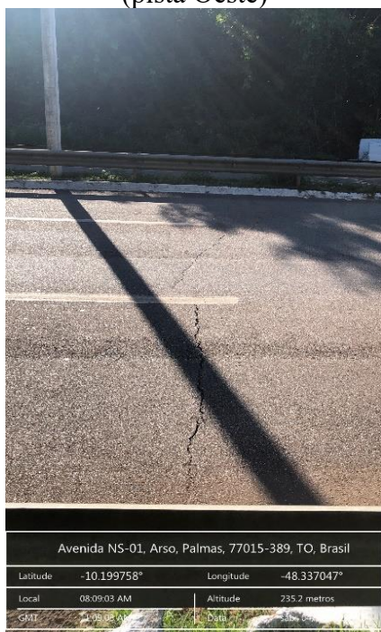
Figura 270 - Trinca na cabeceira Norte (pista Oeste)
