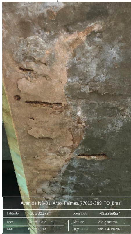
Figura 298 - Corrosão e aspecto saponáceo
