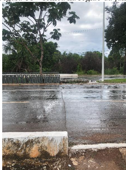
Figura 61 - Trinca na região da junta
