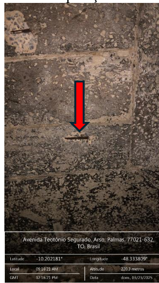
Figura 154 - Exposição de armaduras
