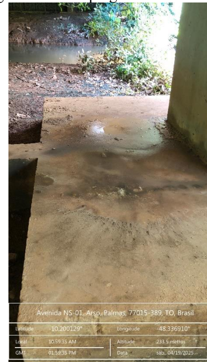
Figura 294 - Respingos de eflorescência
