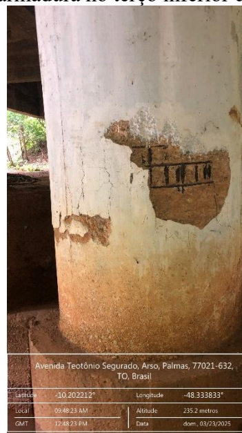
Figura 170 - Deslocamento e exposição de armadura no terço inferior do P5
