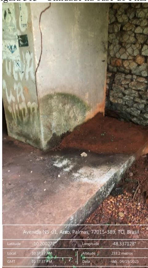
Figura 313 - Umidade na base do Pilar 09
