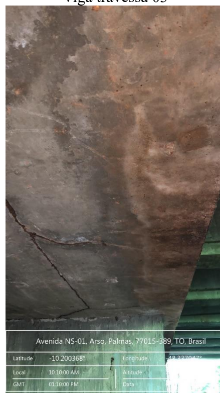
Figura 307 - Manchas de eflorescência na Viga travessa 03
