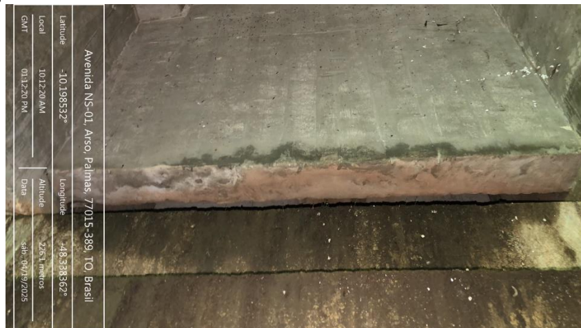
Figura 284 - Sinais de umidade e eflorescência na base da transversina 05
