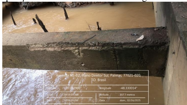
Figura 53 - Exposição e corrosão de armadura na viga de travamento ao Norte
