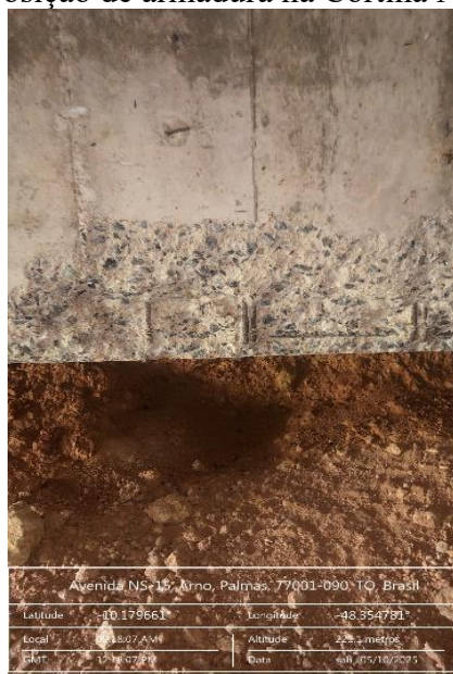
Figura 394 - Falhas de concretagem com exposição de armadura na Cortina Norte
