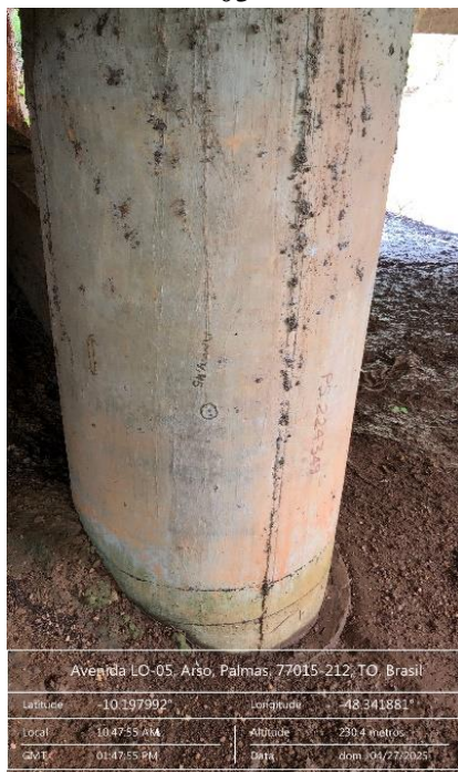
Figura 358 - Indícios de umidade no pilar 03
