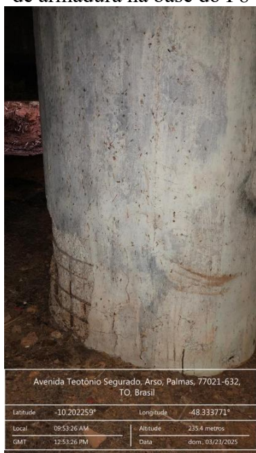
Figura 175 - Deslocamento e exposição de armadura na base do P8
