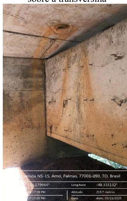
Figura 516 - Escoamento superficial sobre a transversina
