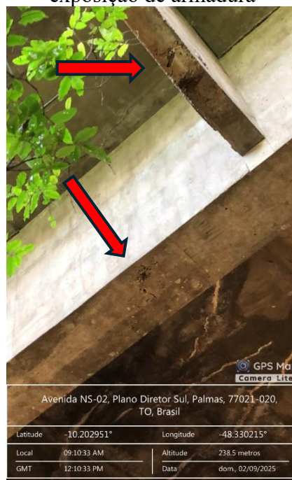
Figura 31 - Falha de concretagem em Longarina e Transversina com exposição de armadura
