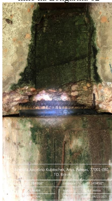
Figura 255 - Corrosão e formação de limo na Longarina 02
