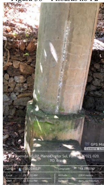
Figura 36 – Fissuras no P2
