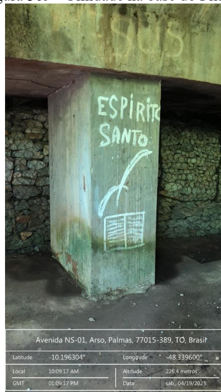
Figura 309 - Umidade na base do Pilar 07
