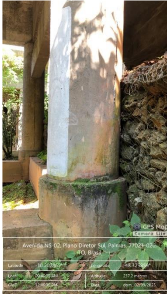
Figura 41 – Umidade na base do P4
