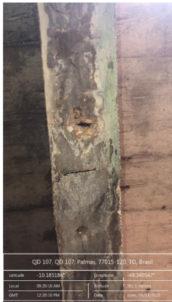
Figura 258 - Deslocamento e exposição de armadura em transversina
