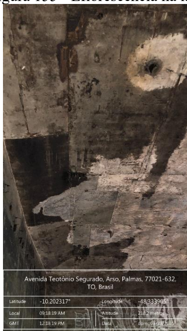
Figura 155 - Eflorescência na laje
