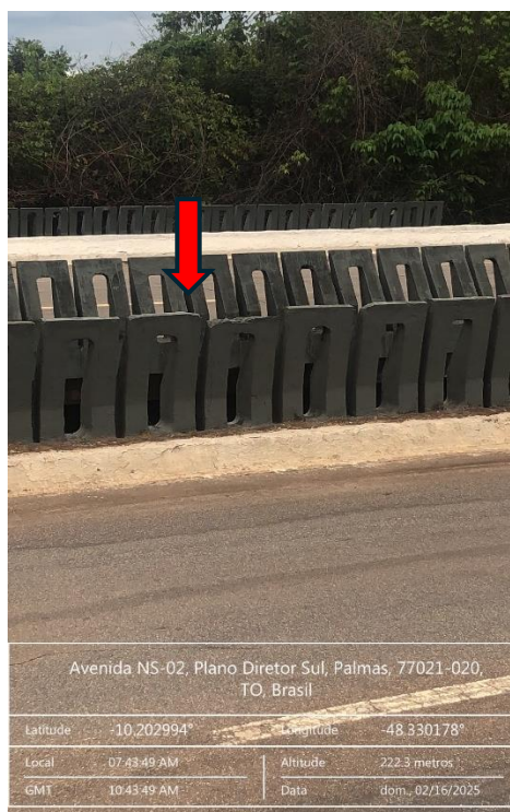
Figura 21 - Avaria no Guarda-Corpo Oeste
