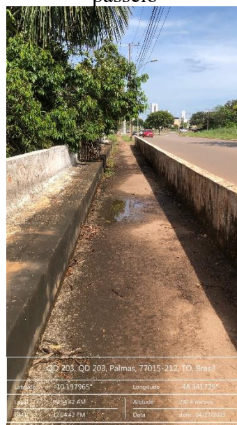
Figura 329 - Umidade nos elementos do passeio
