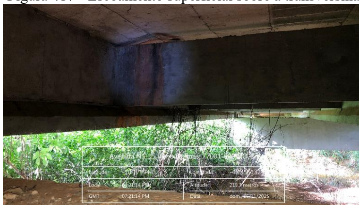
Figura 417 - Escoamento superficial sobre a transversina
