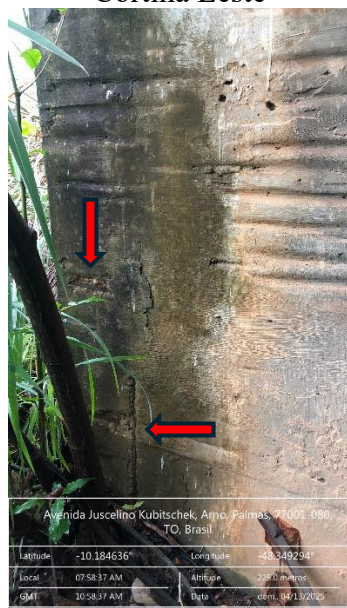
Figura 248 - Umidade e corrosão de armadura na extremidade Norte da Cortina Leste
