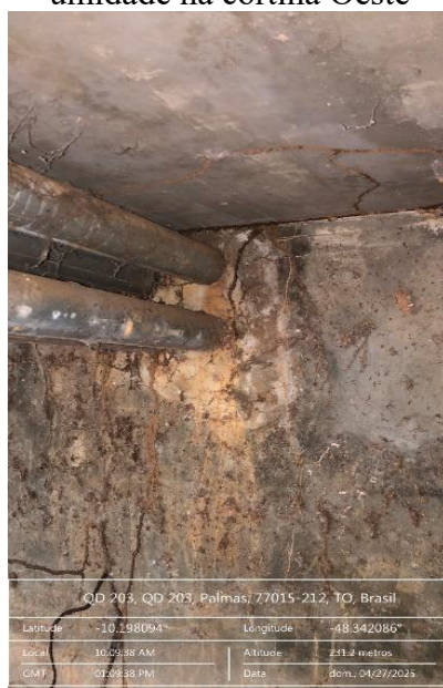
Figura 347 - Sinais de eflorescência e umidade na cortina Oeste
