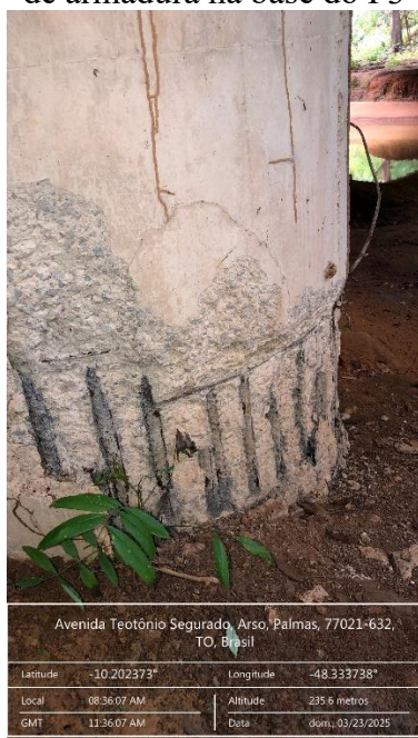
Figura 167 - Deslocamento e exposição de armadura na base do P3
