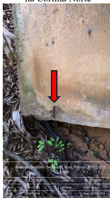
Figura 149 - Deslocamento e umidade na Cortina Norte
