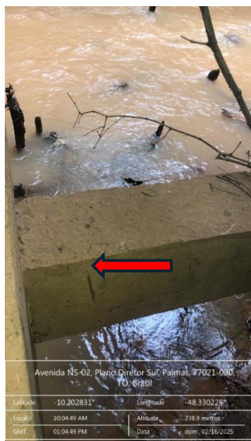
Figura 56 - Exposição de armadura viga de travamento secundária ao Sul
