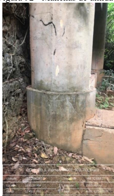
Figura 92 - Manchas de umidade
