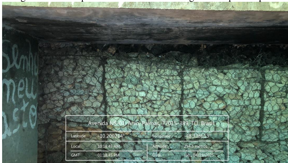
Figura 278 - Rompimento da tela do muro de gabião na parte superior
