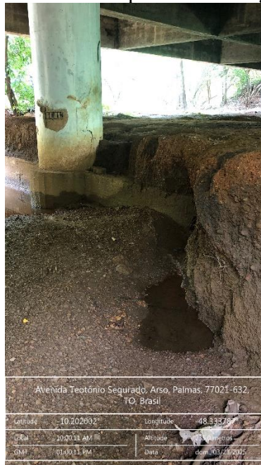
Figura 187 - Erosão próxima à margem sul
