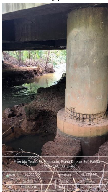
Figura 134 - Erosão em torno do Bloco 04
