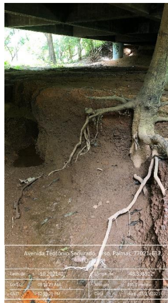
Figura 186 - Erosão próxima à margem sul
