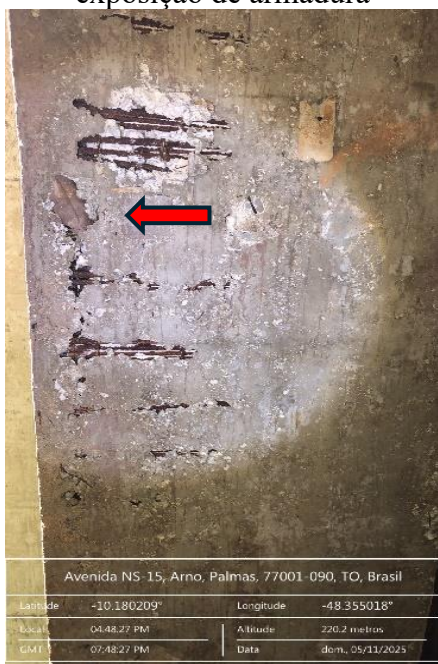
Figura 410 - Falhas de concretagem com exposição de armadura
