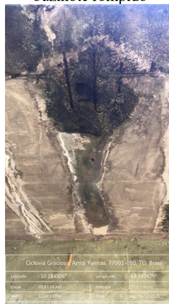
Figura 203 - Eflorescência, limo e corrosão de armadura em ponto de buzinode rompido
