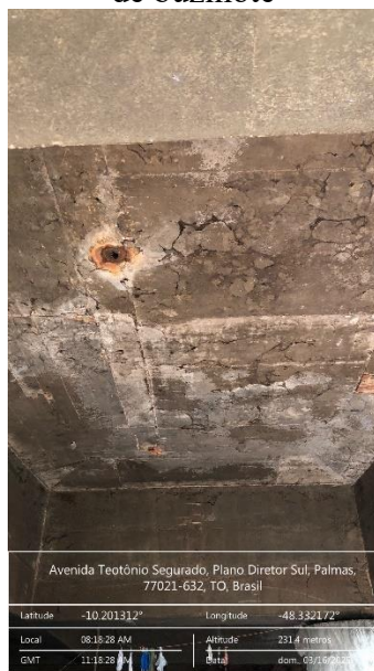
Figura 115 - Eflorescência e ausência de buzinode
