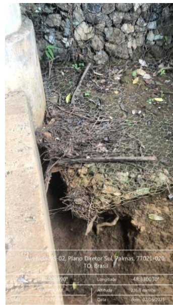
Figura 94 - Aterro cedendo próximo a Bloco de coroamento
