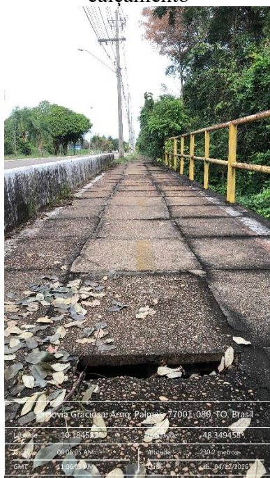
Figura 196 - Rompimento de placa do calçamento
