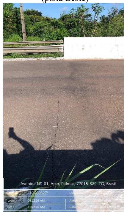
Figura 273 - Trinca na cabeceira Sul (pista Leste)
