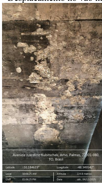
Figura 209 - Deslocamento no vão interno da laje
