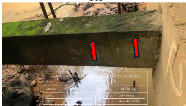
Figura 58 – Umidade e início de deslocamento na viga de travamento secundária ao Sul
