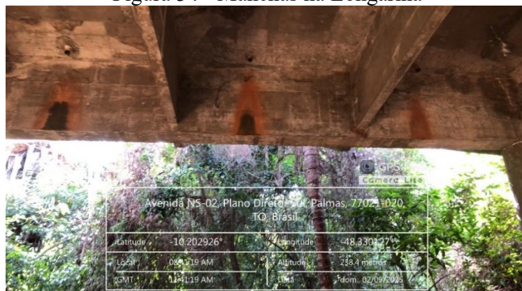
Figura 34 - Manchas na Longarina
