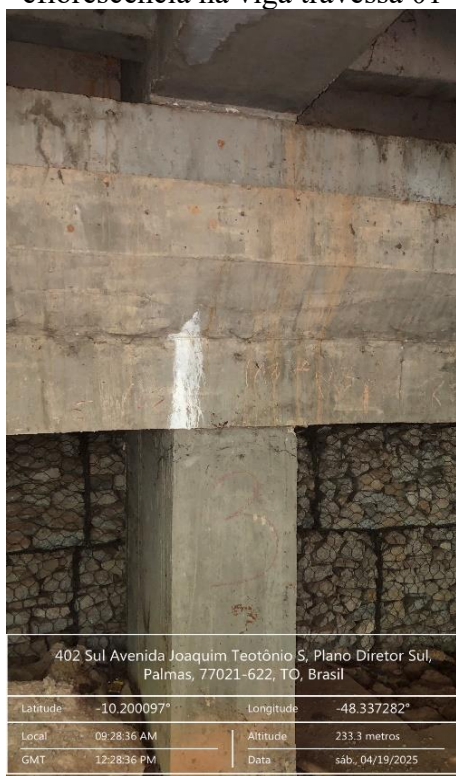
Figura 287 - Mancha característica de eflorescência na viga travessa 01
