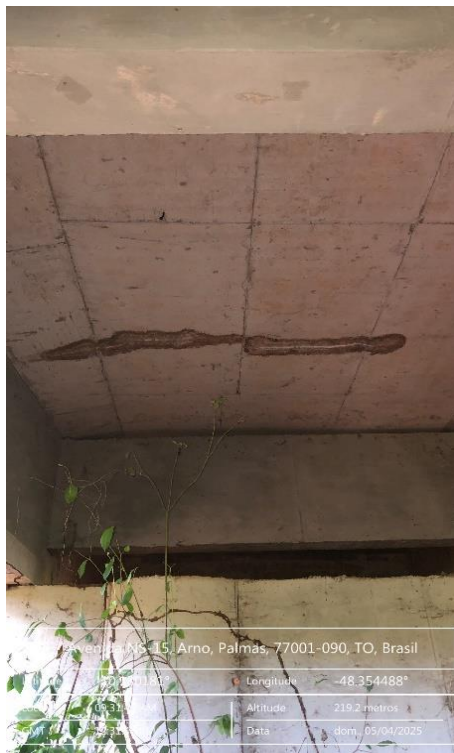
Figura 373 - Eflorescência próxima à cabeceira Norte
