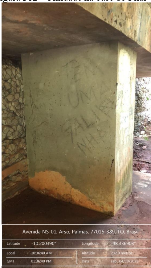
Figura 312 - Umidade na base do Pilar 09
