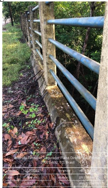
Figura 102 - Manchas de umidade
