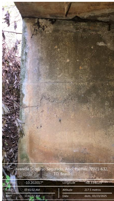
Figura 150 - Umidade na Cortina Norte
