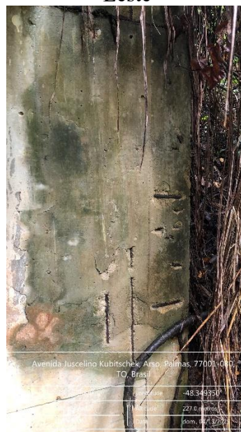
Figura 249 - Umidade e corrosão de armadura na extremidade Sul da Cortina Leste
