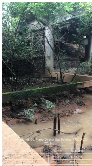
Figura 57 - Formação de Limo na viga de travamento secundária ao Sul
