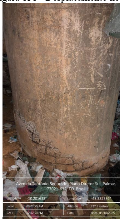
Figura 131 - Desplacamento no P8
