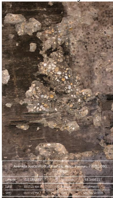
Figura 207 - Deslocamento no vão interno da laje
