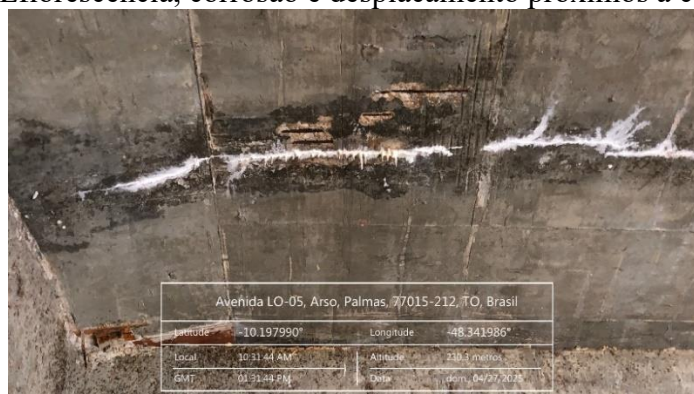
Figura 344 - Eflorescência, corrosão e deslocamento próximos à cabeceira Oeste
