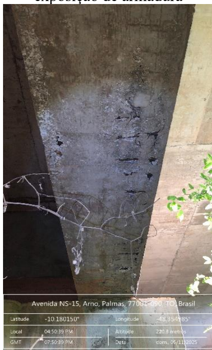
Figura 412 - Falhas de concretagem com exposição de armadura
