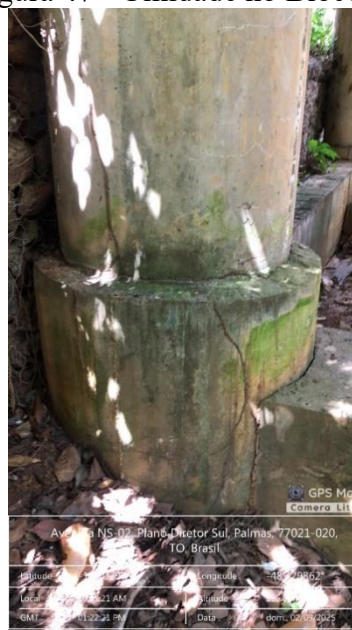
Figura 47 - Umidade no Bloco 02
