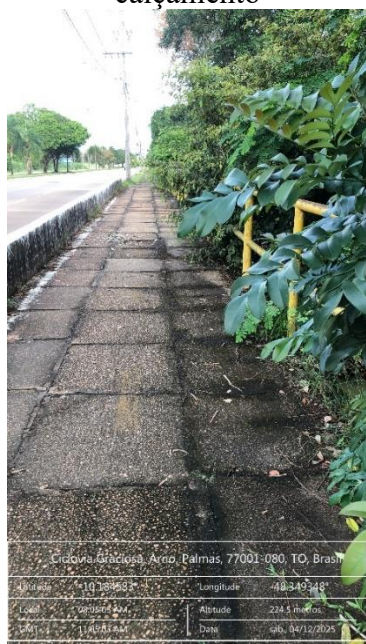
Figura 194 - Manchas de umidade no calçamento
