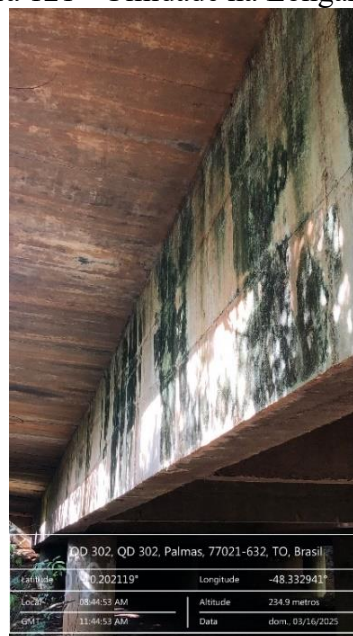
Figura 121 - Umidade na Longarina 04
