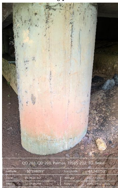
Figura 356 - Indícios de umidade no pilar 01
