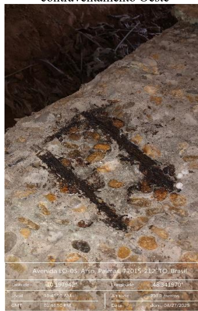
Figura 355 - Desplacamento na viga de contraentramento Oeste
