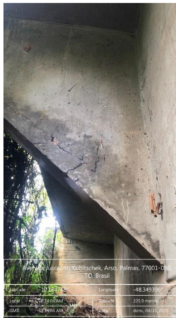
Figura 257 - Deslocamento em transversina
