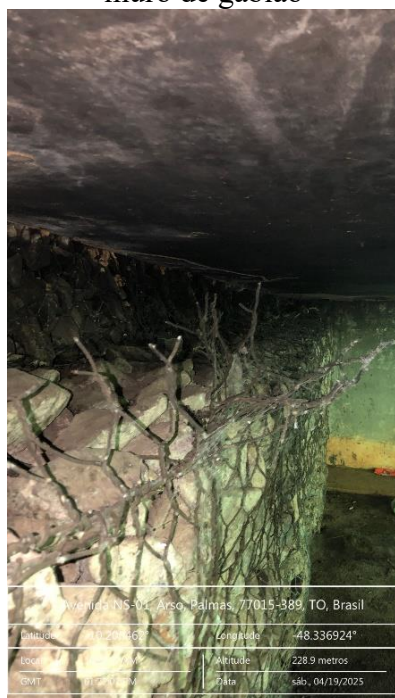
Figura 276 - Rompimento da tela do muro de gabião
