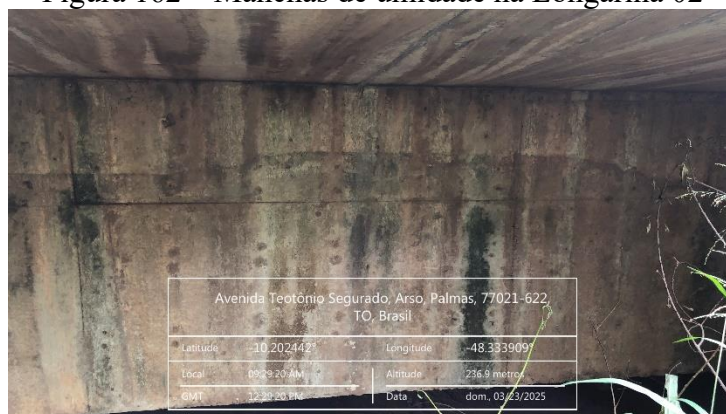
Figura 162 – Manchas de umidade na Longarina 02
