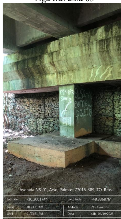
Figura 304 - Manchas de umidade na Viga travessa 03
