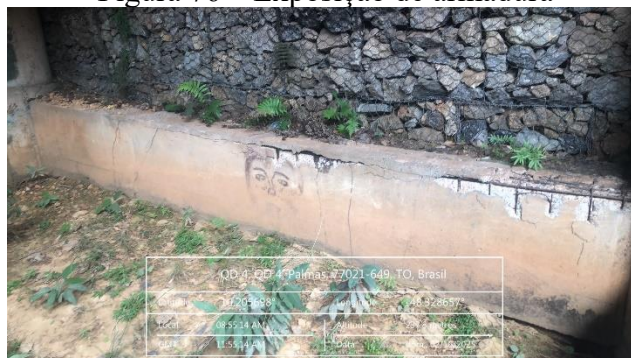
Figura 76 – Exposição de armadura
