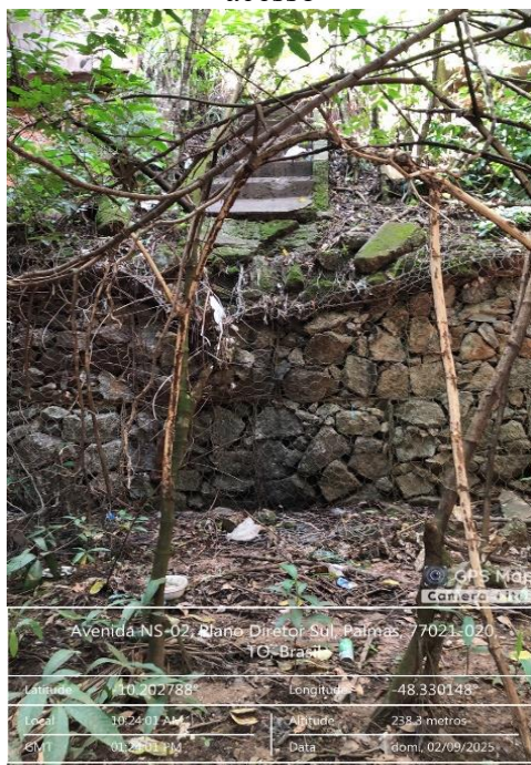
Figura 22 - Queda acentuada ao final do acesso
