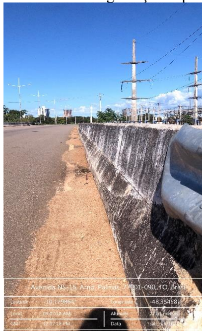
Figura 389 - Leve degradação superficial
