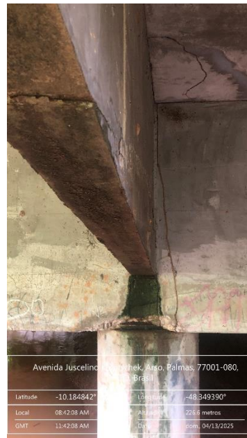
Figura 259 - Deslocamento em transversina
