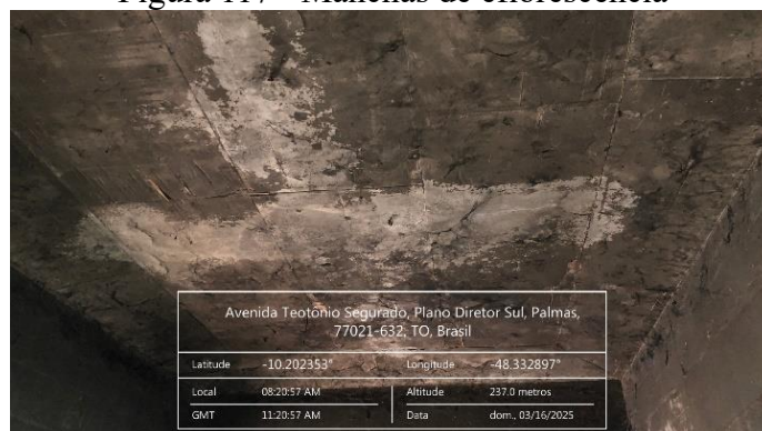
Figura 117 - Manchas de eflorescência
