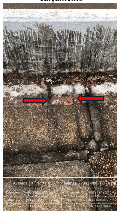
Figura 197 - Exposição de armadura do calçamento
