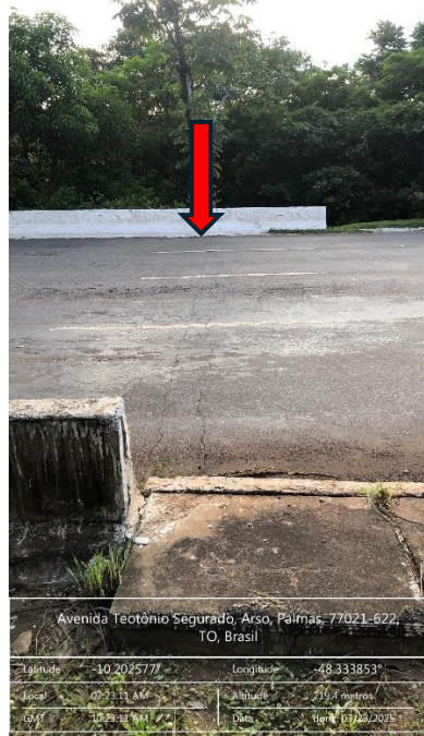
Figura 145 – Trinca e desnível na pista
