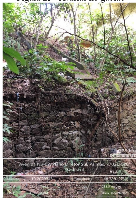
Figura 23 - Avarias no gabião
