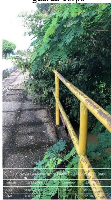
Figura 195 - Corrosão superficial no guarda-corpo
