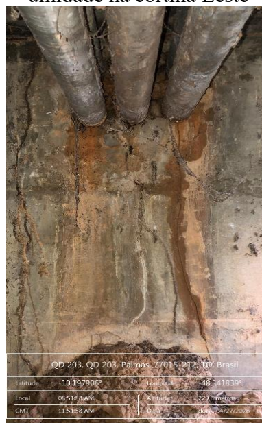
Figura 346 - Sinais de eflorescência e umidade na cortina Leste
