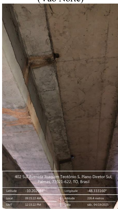
Figura 280 - Mancha na longarina 05 (Vão Norte)
