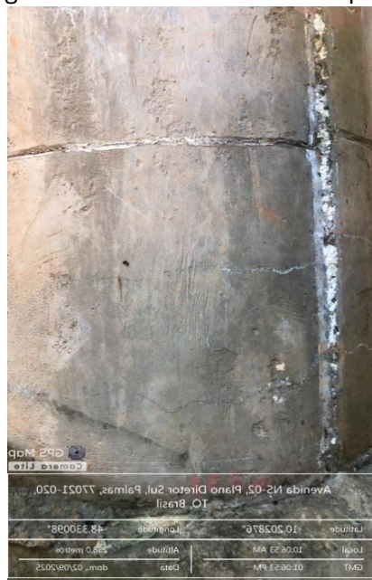
Figura 39 – Fissuras em base de pilar
