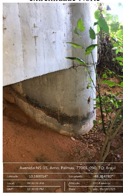
Figura 423 - Umidade em pilar da extremidade Norte
