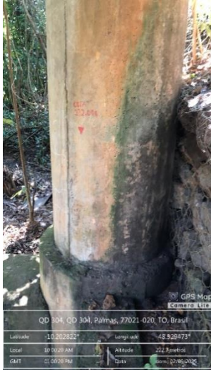
Figura 43 – Manchas de umidade no P2
