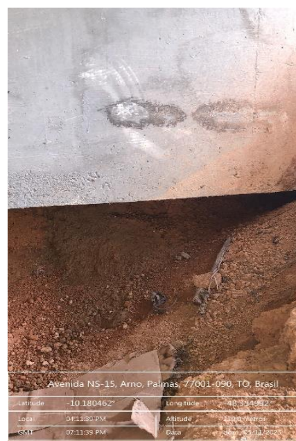
Figura 395 - Eflorescência na cortina Sul
