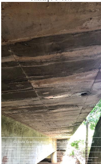
Figura 198 - Umidade ao longo do balanço Norte
