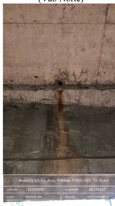
Figura 281 - Mancha na longarina 01 (Vão Norte)
