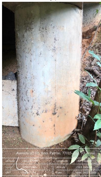
Figura 359 - Indícios de umidade no pilar 04
