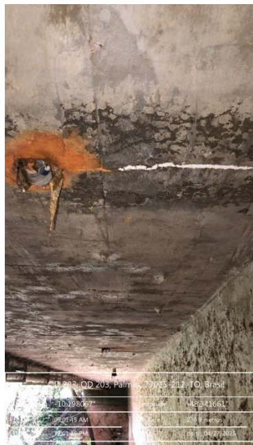
Figura 337 - Eflorescência no balanço Sul
