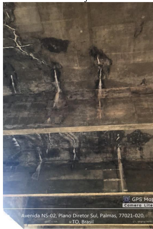
Figura 25 - Eflorescência em vãos diversos da laje
