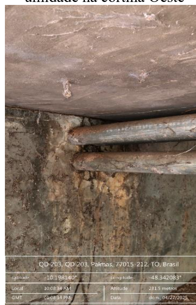
Figura 348 - Sinais de eflorescência e umidade na cortina Oeste
