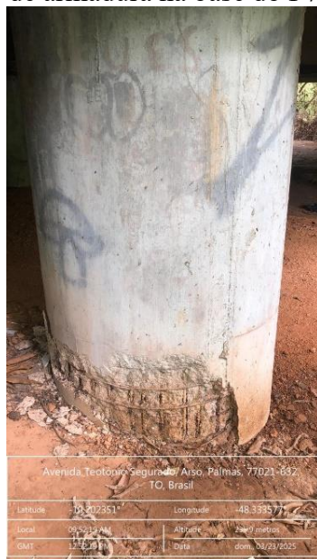
Figura 173 – Deslocamento e exposição de armadura na base do P7
