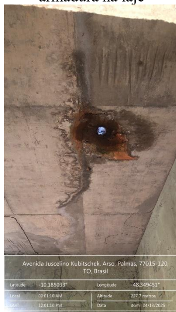
Figura 240 - Umidade e corrosão de armadura na laje
