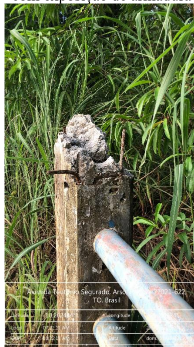
Figura 144 – Quebra do topo do elemento com exposição de armadura
