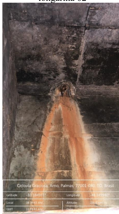
Figura 217 - Mancha no lado interno da longarina 02
