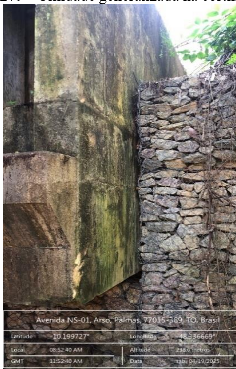
Figura 279 - Umidade generalizada na cortina lateral
