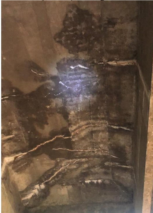
Figura 26 - Eflorescência com ponto de percolação da água
