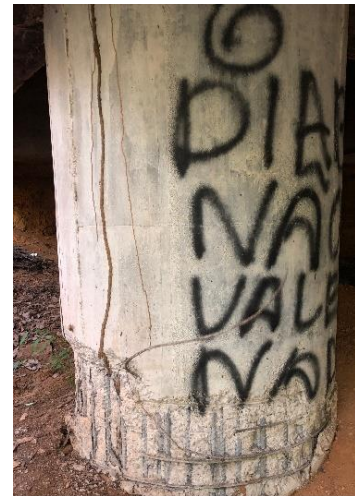
Figura 166 - Deslocamento e exposição de armadura na base do P3
