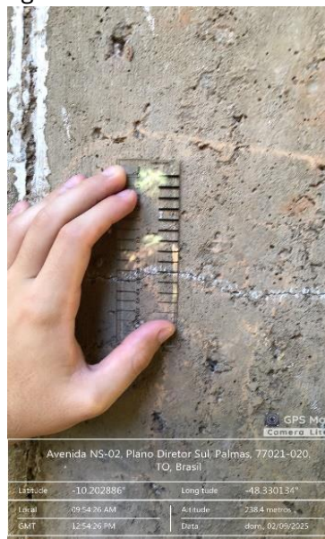
Figura 38 – Abertura da fissura
