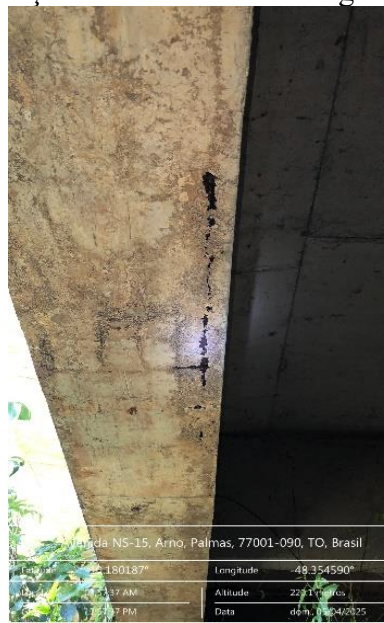
Figura 378 - Falha de concretagem e exposição de armadura na Longarina 01
