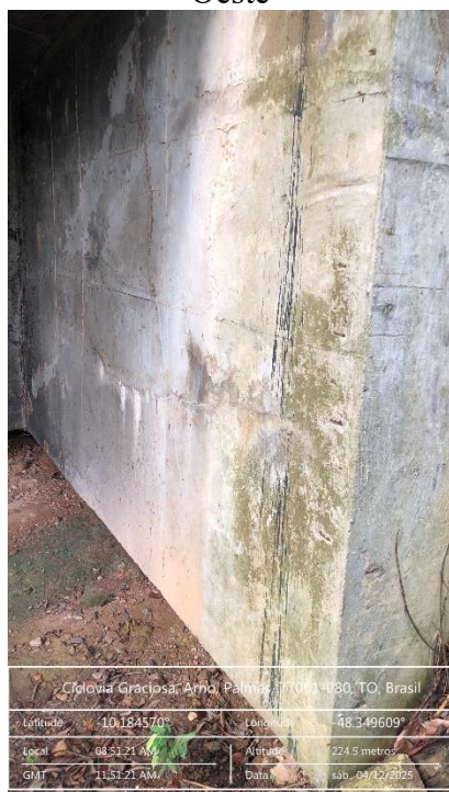
Figura 210 - Eflorescência e manchas de umidade na extremidade Norte da cortina Oeste
