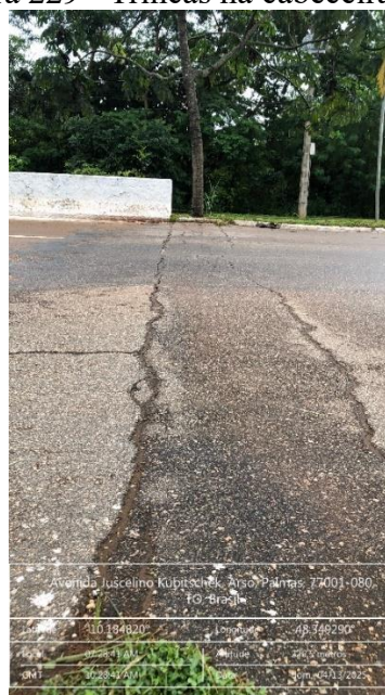
Figura 229 - Trincas na cabeceira Leste
