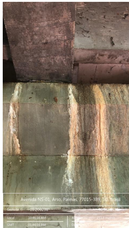
Figura 192 - Eflorescência na extremidade Leste
