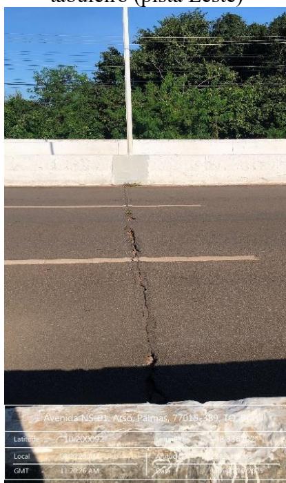
Figura 272 - Trinca no centro do tabuleiro (pista Leste)
