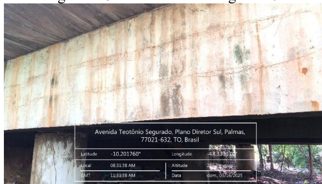
Figura 118 - Manchas na Longarina 01
