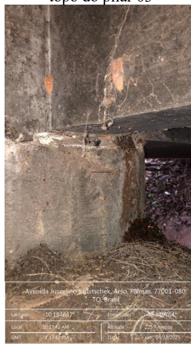
Figura 215 - Cobrimento insuficiente no topo do pilar 03
