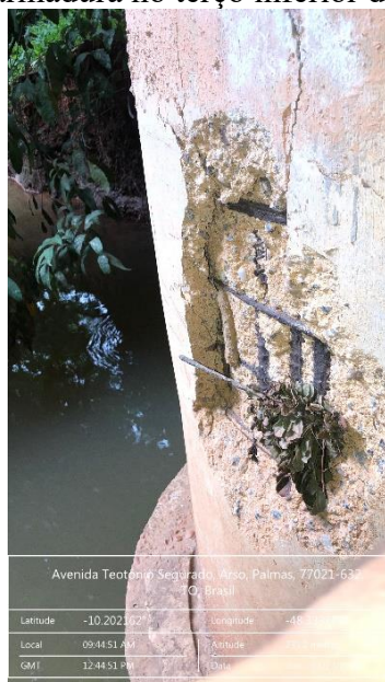
Figura 169 - Deslocamento e exposição de armadura no terço inferior do P4
