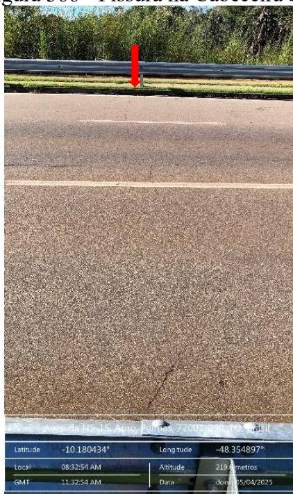
Figura 366 - Fissura na Cabeceira Sul
