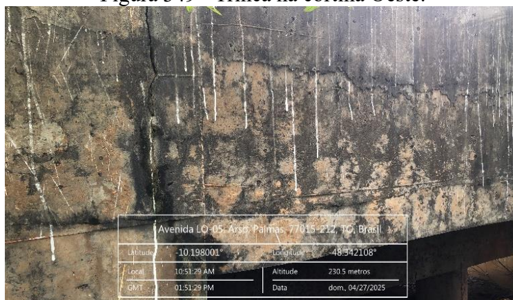
Figura 349 - Trinca na cortina Oeste.
