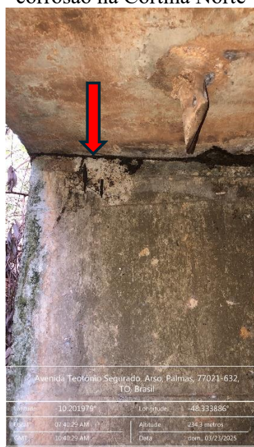
Figura 148 – Deslocamento e início de corrosão na Cortina Norte
