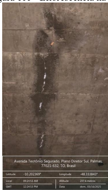
Figura 111 - Eflorescência na laje
