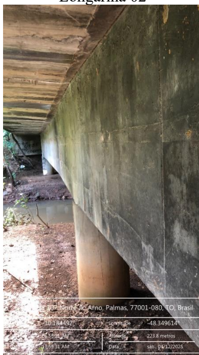
Figura 216 - Umidade no lado externo da Longarina 02
