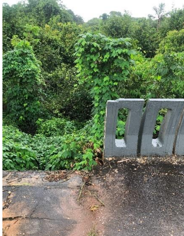
Figura 60 - Insuficiência de comprimento no Guarda-Corpo
