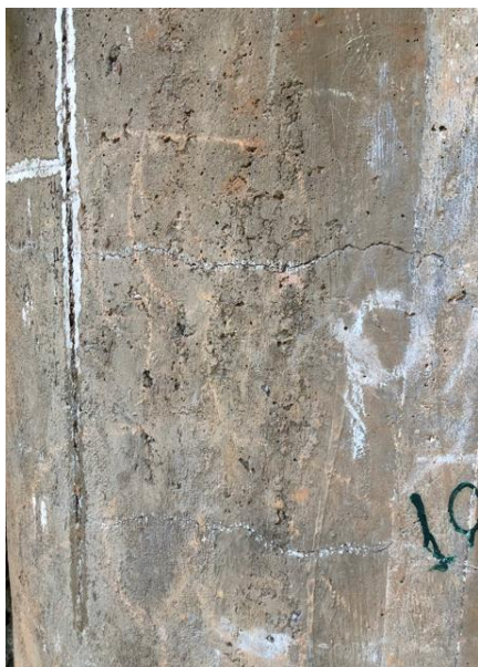
Figura 37 – Fissuras horizontais em Pilar
