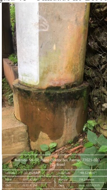
Figura 46 - Umidade no Bloco 04
