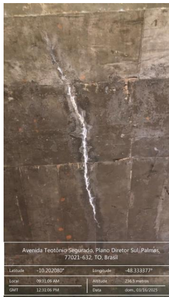
Figura 113 - Eflorescência na laje
