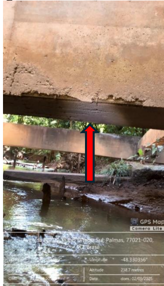
Figura 50 - Exposição de armadura em viga de travamento ao Oeste
