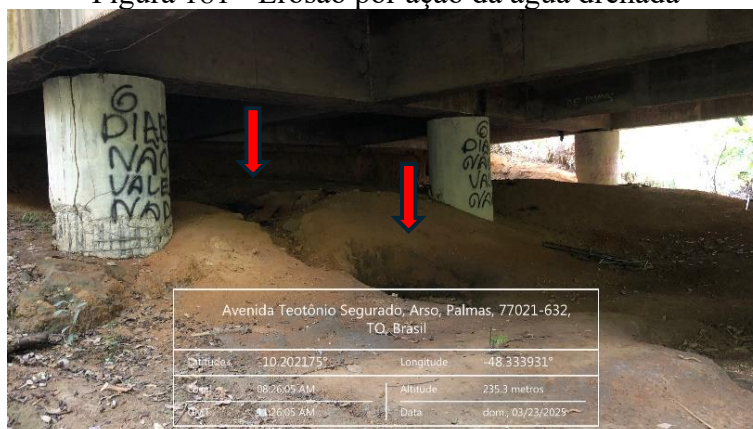
Figura 181 - Erosão por ação da água drenada
