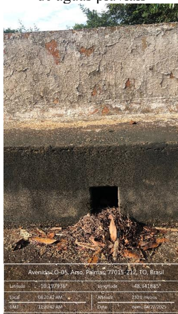
Figura 326 - Obstrução parcial do coletor de águas pluviais
