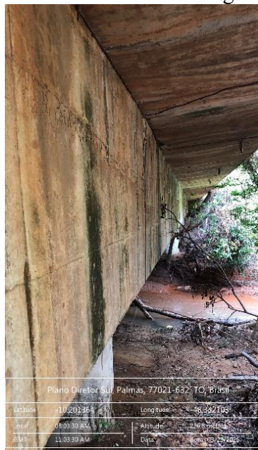
Figura 160 - Umidade na Longarina 01
