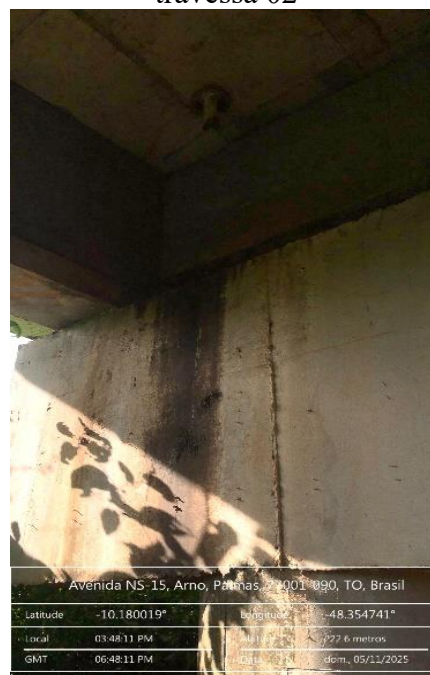
Figura 421 - Manchas de umidade na travessa 02
