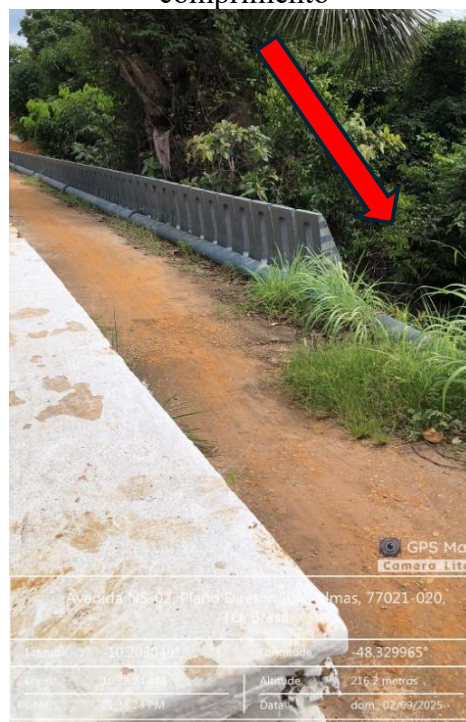
Figura 18 - Insuficiência de comprimento
