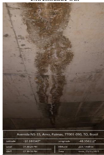
Figura 407 - Manchas de eflorescência na extremidade Sul
