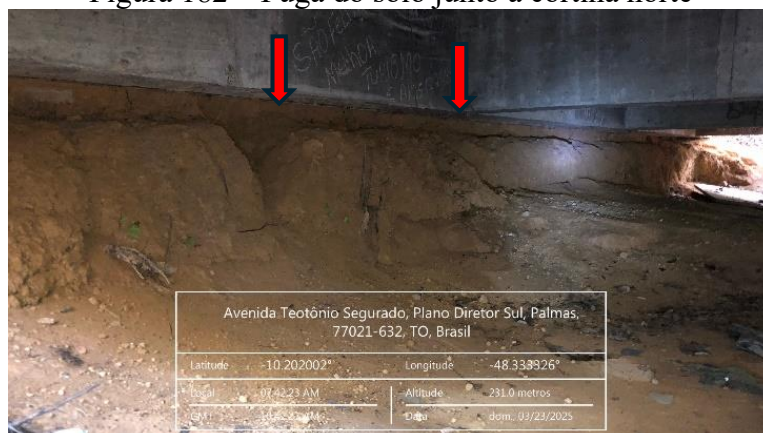
Figura 182 – Fuga do solo junto à cortina norte
