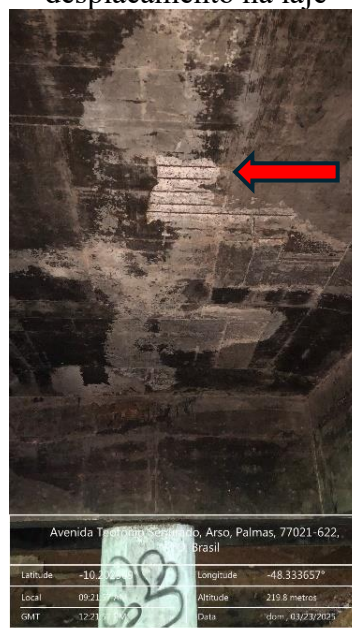
Figura 156 - Eflorescência e deslocamento na laje
