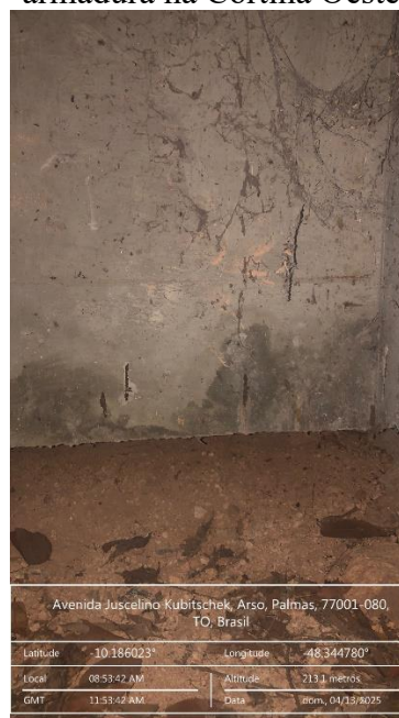
Figura 253 - Umidade e exposição de armadura na Cortina Oeste
