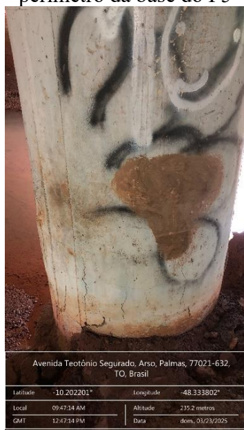
Figura 171 – Fissuras ao longo do perímetro da base do P5
