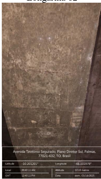
Figura 120 - Exposição de armadura na Longarina 02
