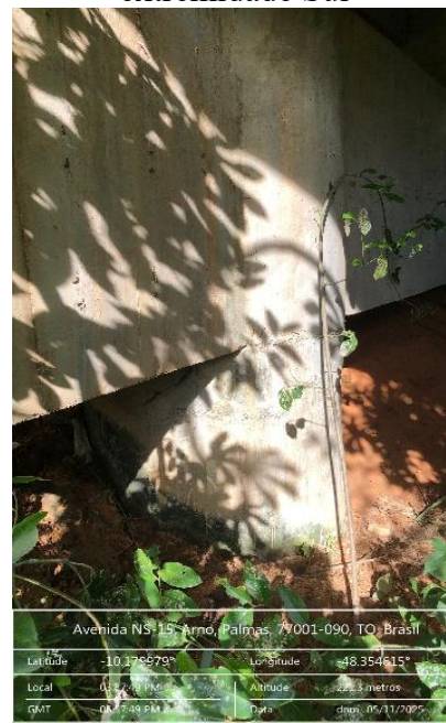
Figura 425 - Umidade em pilar da extremidade Sul
