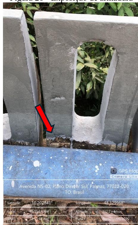
Figura 20 - Exposição de armadura
