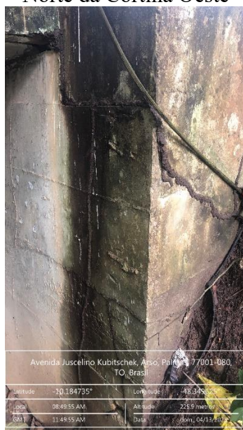
Figura 250 - Umidade na extremidade Norte da Cortina Oeste
