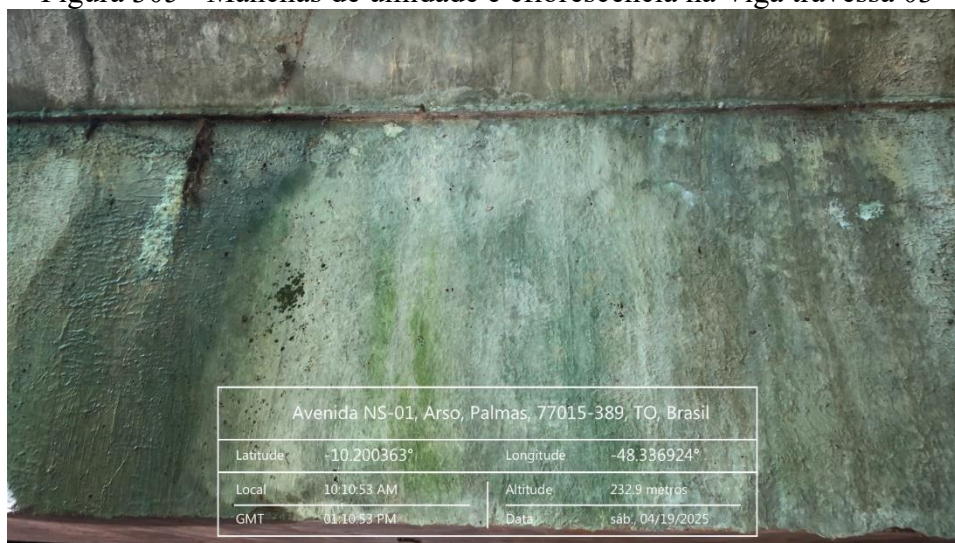
Figura 305 - Manchas de umidade e eflorescência na Viga travessa 03
