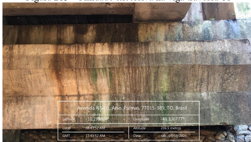
Figura 285 - Umidade excessiva na viga travessa 01
