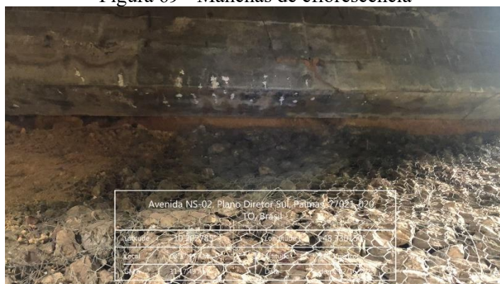
Figura 69 - Manchas de eflorescência
