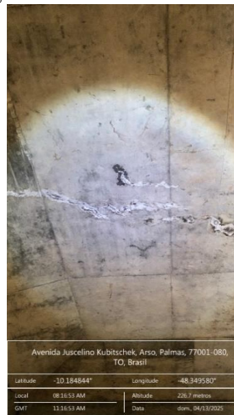
Figura 243 - Eflorescência na Laje
