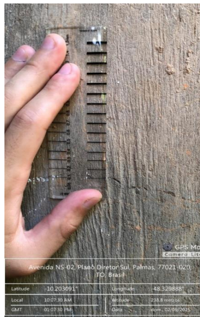
Figura 40 - Abertura da fissura
