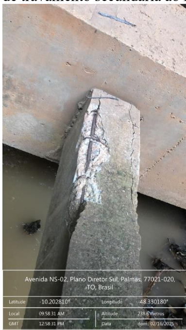
Figura 54 - Exposição de armadura em viga de travamento secundária ao Norte
