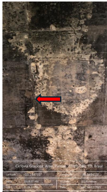
Figura 208 - Deslocamento e exposição de armadura em vão interno da laje
