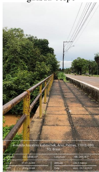
Figura 226 - Corrosão superficial no guarda-corpo
