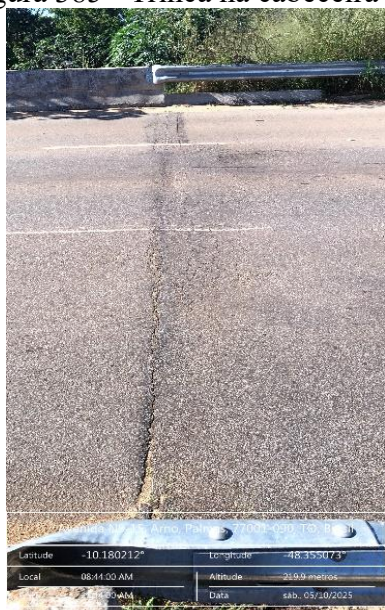
Figura 385 - Trinca na cabeceira Sul
