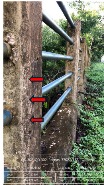
Figura 103 – Fissura no guarda-corpo
