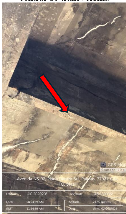
Figura 30 - Falha de concretagem em vão central de transversina
