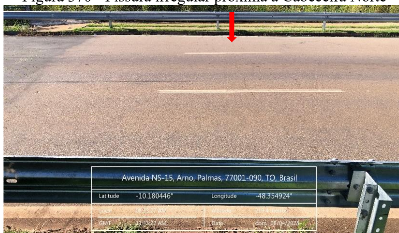
Figura 370 - Fissura irregular próxima à Cabeceira Norte
