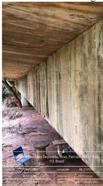
Figura 161 - Umidade na Longarina 01
