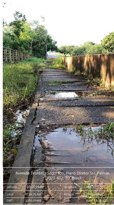
Figura 98 - Degradação do calçamento
