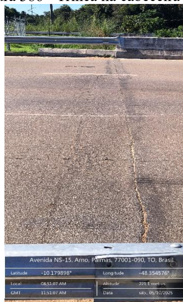
Figura 386 - Trinca na cabeceira Norte
