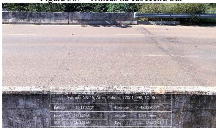
Figura 387 - Trincas na cabeceira Sul
