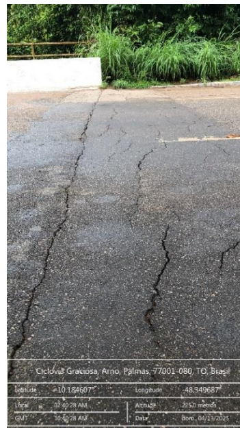
Figura 231 - Trincas na cabeceira Oeste
