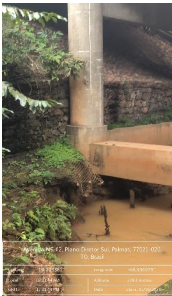
Figura 93 - Aterro cedendo próximo a Bloco de coroamento
