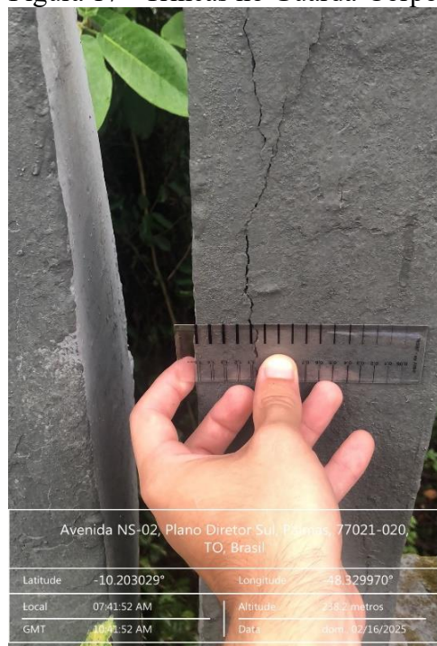
Figura 17 - Trincas no Guarda-Corpo
