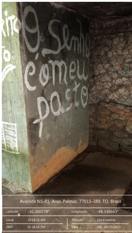
Figura 310 - Umidade na base do Pilar 07
