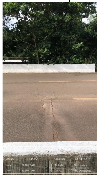
Figura 190 - Trincas no pavimento localizadas acima dos pilares Oeste
