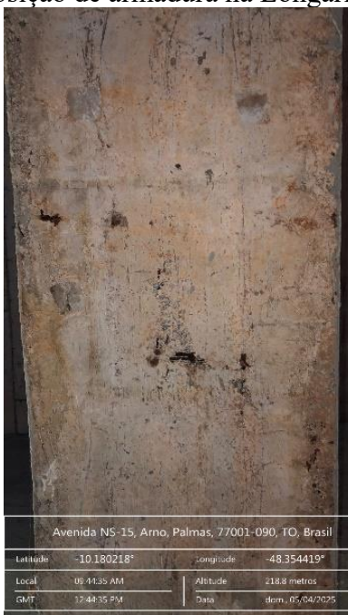
Figura 380 - Falha de concretagem e exposição de armadura na Longarina 02
