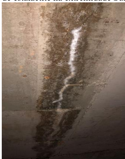
Figura 408 - Eflorescência com formação de estalactite na extremidade Sul
