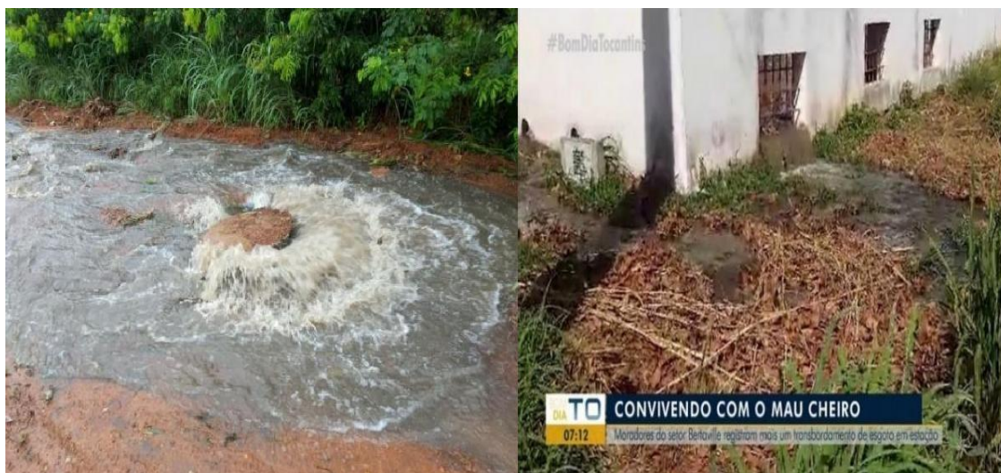
Figura 1- Vazamentos de esgoto na ETE Aurenny, Setor Bertaville, Palmas (TO).
