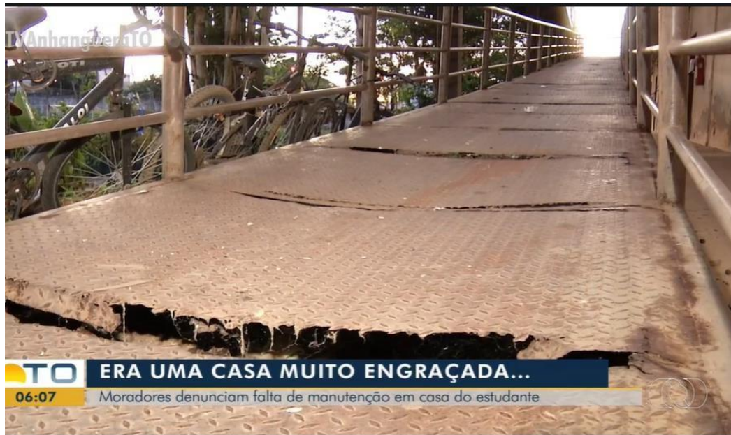
Figura 6 - Reportagem, rampa em condições precárias
