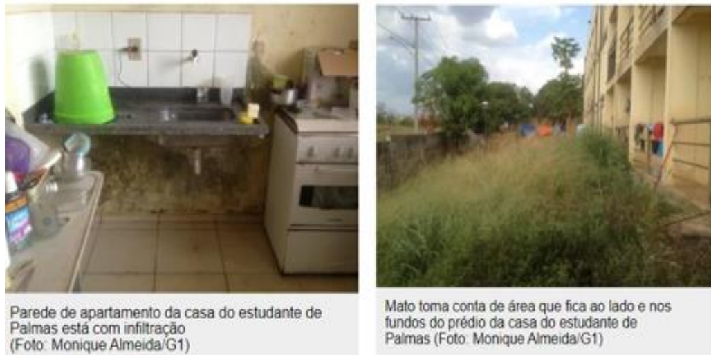
Figura 5 - Infiltração e falta de manutenção no entorno
