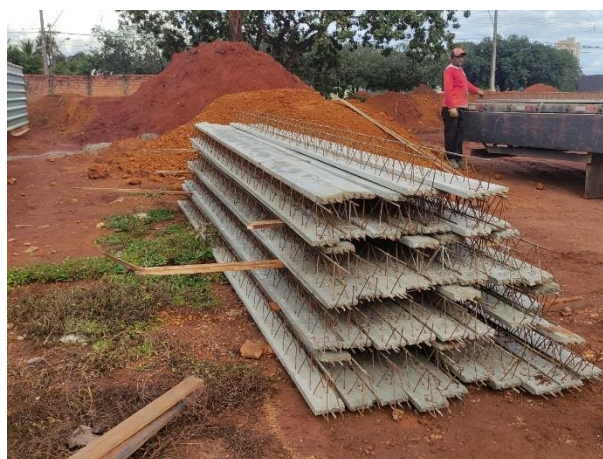
Figura 12 – Painéis treliçados armazenados fora da obra
