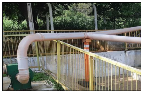
Figura 5: Tubulação responsável pela coleta de gases do Tratamento Preliminar, suspensão cone e tijolo em local desnivelado.
