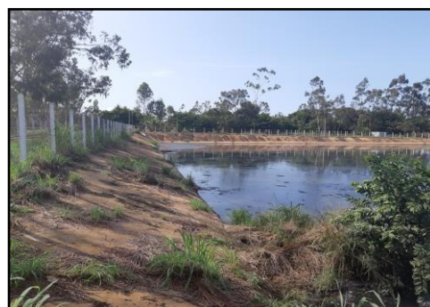
Figura 9: Presença de vegetação nos taludes da Lagoa.
