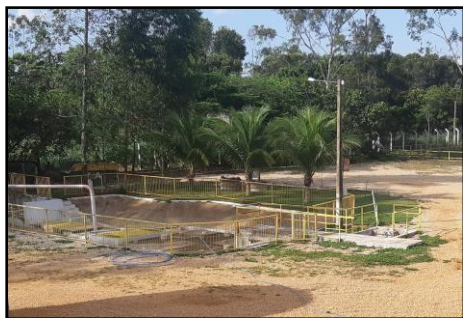
Figura 5: Falta placas de identificação do processo, reforma de guarda corpo.
