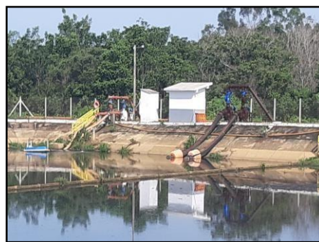
Figura 13: Vista da Estação Elevatória que bombeia o efluente da lagoa de maturação para o processo de flotação.
