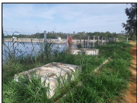
Figura 6: Vista da caixa de passagem da entrada do esgoto coberta pela vegetação.
