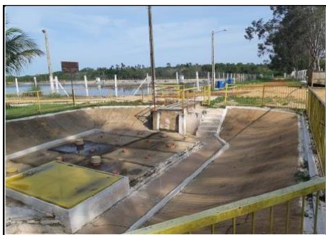
Figura 3: Tratamento Preliminar (entrada do esgoto bruto, gradeamento, desarenador manual, medidor de vazão tipo calha Parshall)
