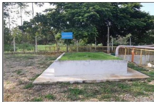
Figura 4: Vista do biofiltro para controle de odores do tratamento preliminar.
