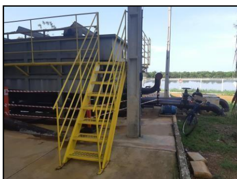
Figura 14: Vista da lateral e de acesso ao Flotador por Ar Dissolvido (FDA).
