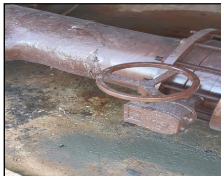
Figura 19: Tubulação do sistema de flotação sob o flotador apresenta ruptura causando vazamento.
