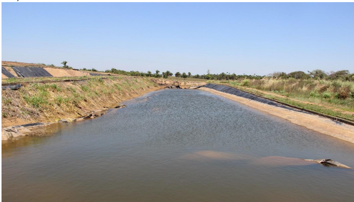
Figura 32 - Célula de aterro sanitário de Augustinópolis-TO inundada e parte da proteção do solo deteriorada.
