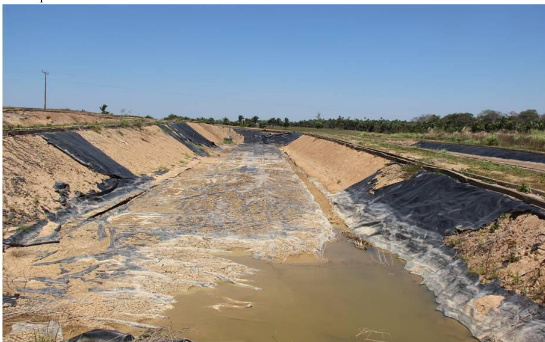
Figura 11 - Célula de aterro sanitário deteriorada. Água da chuva acumula-se em pontos específicos da célula.
