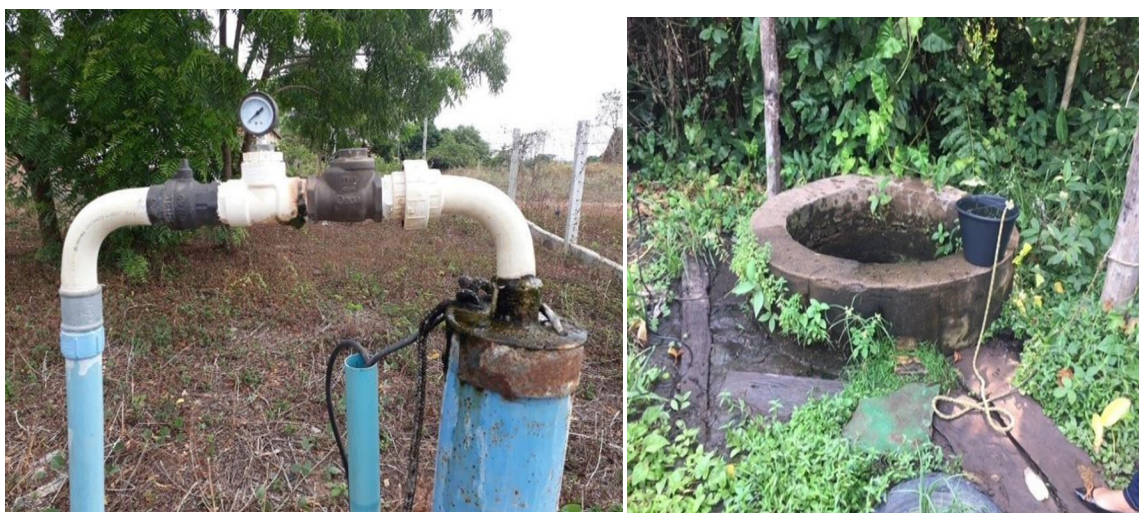
Figura 24: Poços semiartesiano e poço artesanal (cisterna) assentamento Palmares, 2023.
