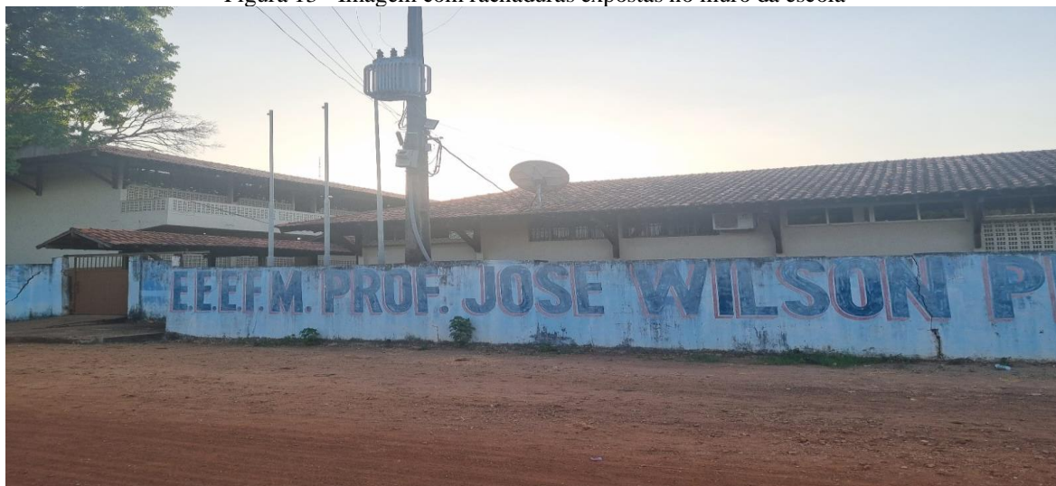
Figura 13 - Imagem com rachaduras expostas no muro da escola
