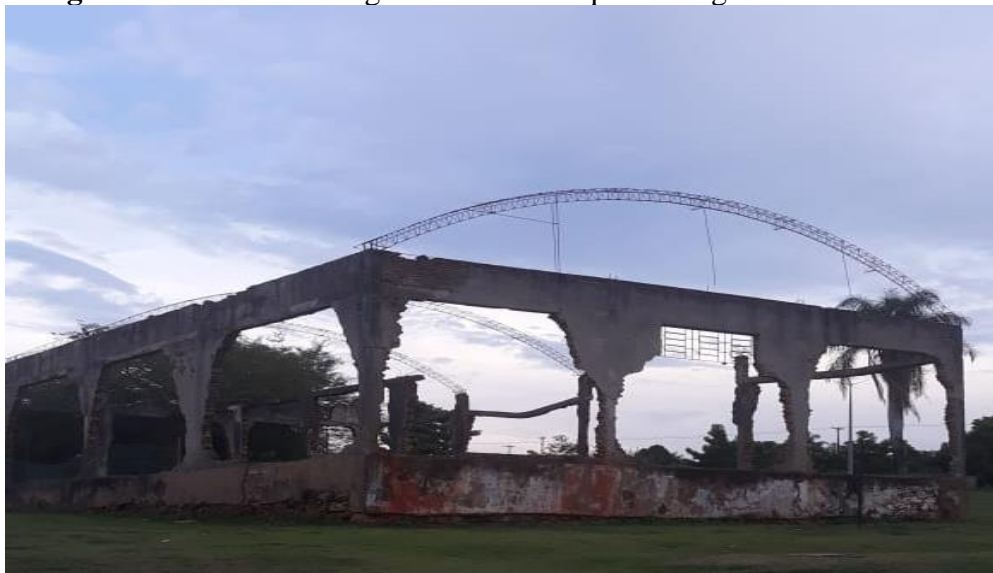
Figura 6 - Ruínas da antiga fabrica no Parque Ecológico Urbano Cimba
