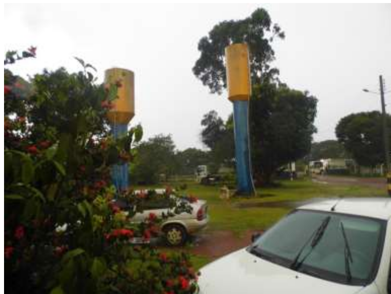
Figura 05 – Caixa d'água e ao seu pé uma bomba de cloro –Matadouro-Frigorífico ASSOCARNE, 2017.
