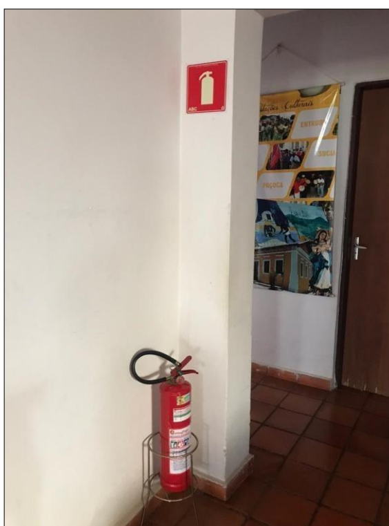
Fotografia 15 - Extintor de incêndio do MHCA
