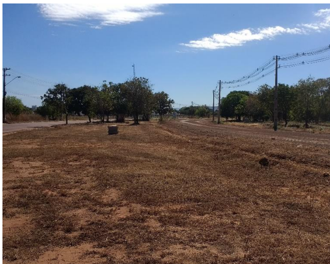
Figura 22 - Construção e duplicação do trecho da avenida NS-15, entre a avenida JK e a ARNO's (trecho em obras). Foto: Bezerra, abr. 2017.
