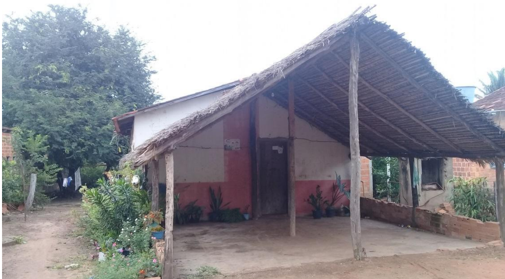
Figura 5. Casa com o telhado da palha do babaçu no Povoado Centro dos Borges (Riachinho -TO)
