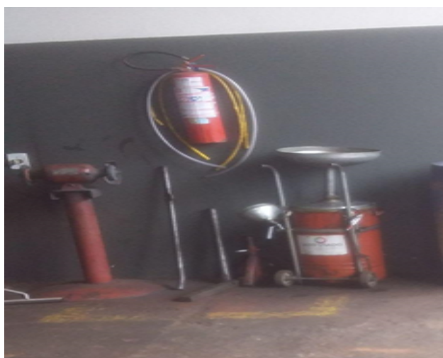
Figura 06 Coletor De Óleo Lubrificante Usado
