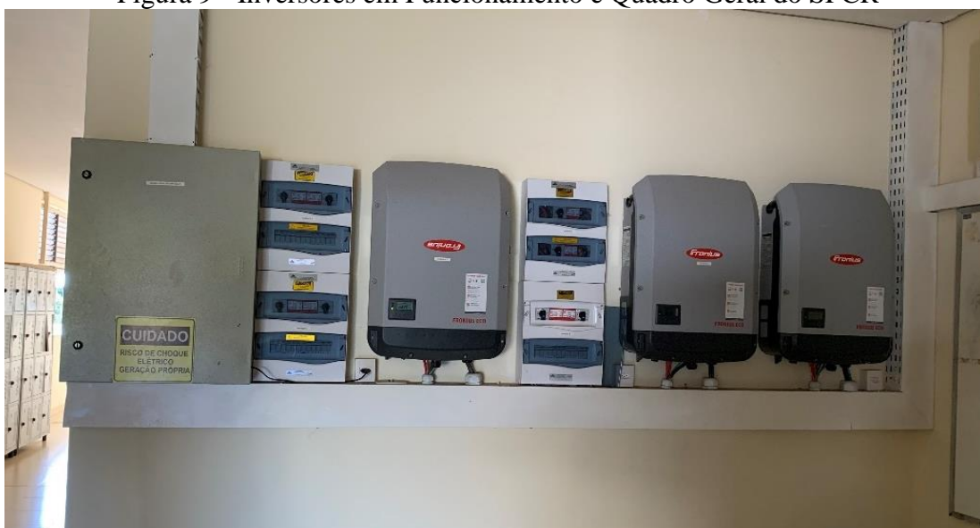
Figura 9 - Inversores em Funcionamento e Quadro Geral do SFCR
