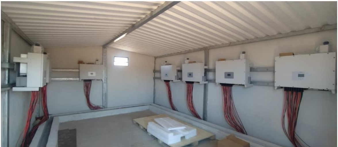
Figura 10 – Casa de abrigo dos inversores
