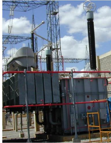
Figura 2 - Transformador de potência monofásico.
