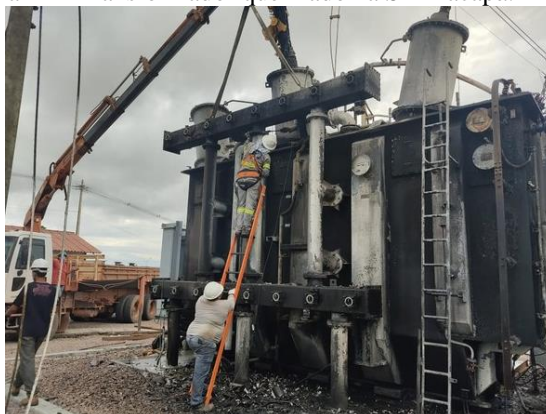
Figura 21 - Transformador queimado na SE Macapá.
