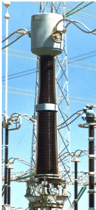
Figura 4 - Transformador de corrente em uma subestação.
