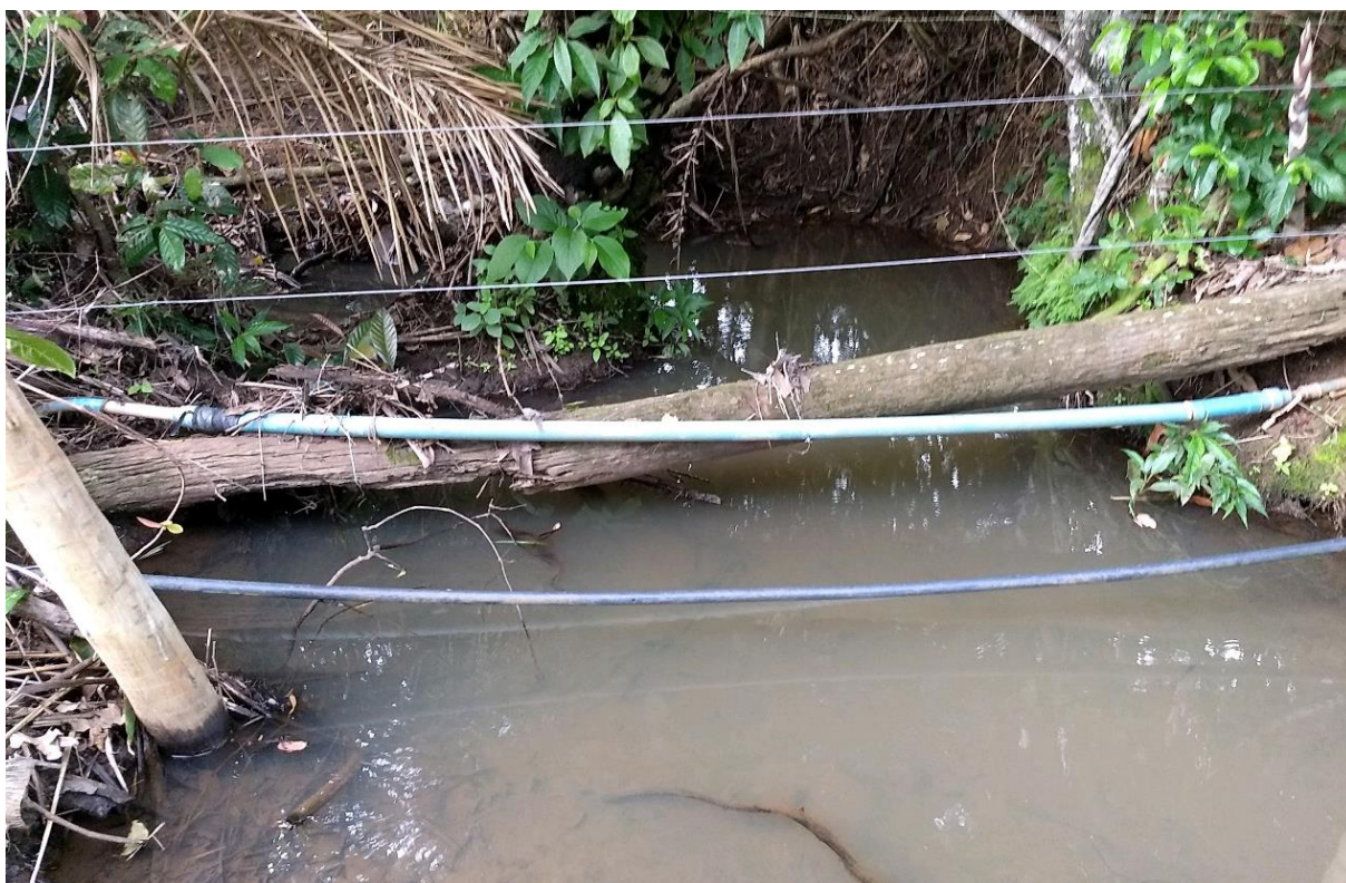
Figura 26 – Vazamento: Ponto com Reparo Improvisado
