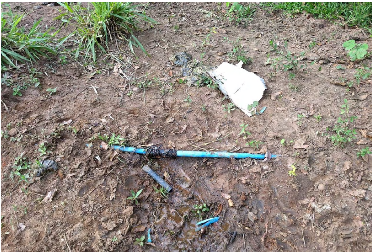
Figura 25 – Vazamento: Ponto com Reparo com Borracha
