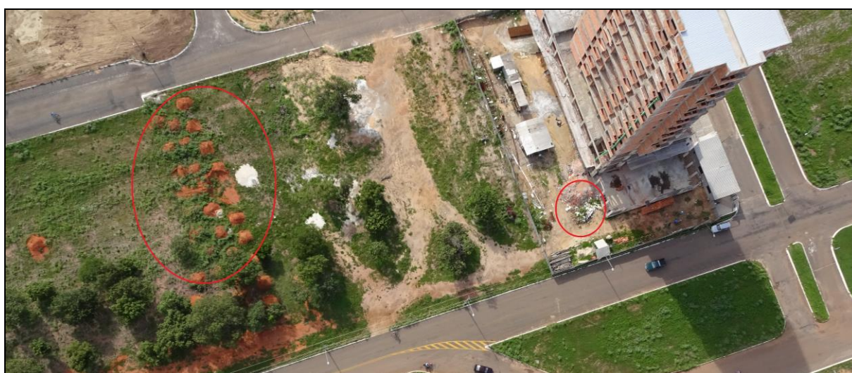
Figura 18. Resíduo de obra em fase de infraestruturação, escavação das fundações na quadra 107 norte. (Fonte: autor)
