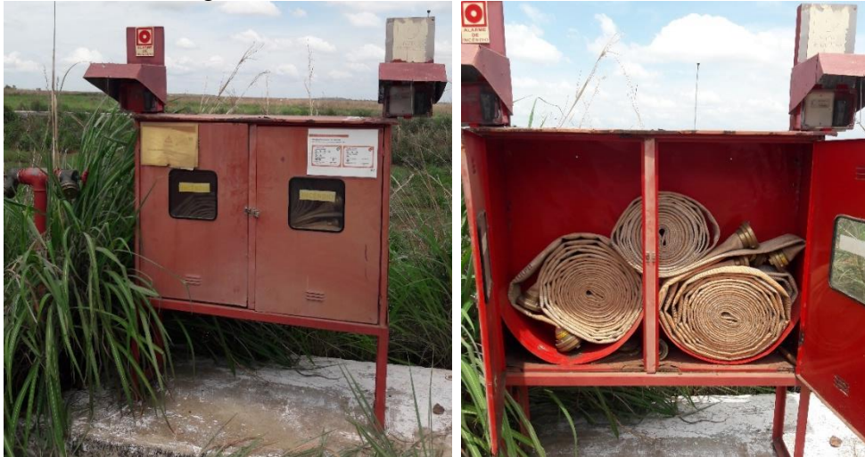
Figura 16 – Hidrante na entrada do tombador
