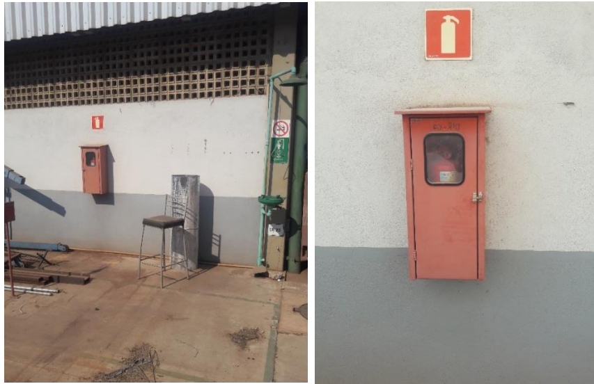
Figura 33 – Extintores do DIR
