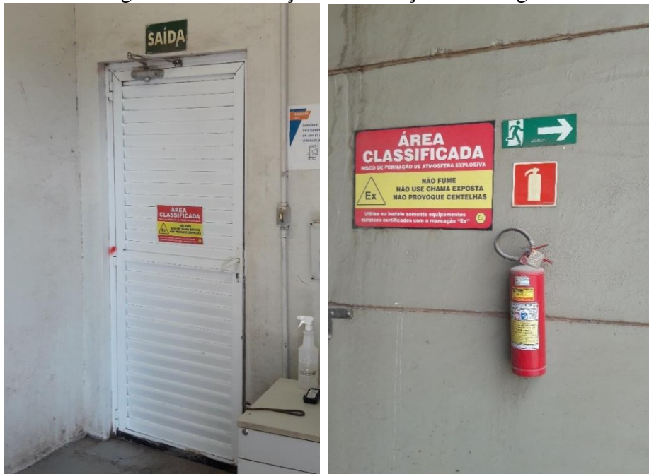
Figura 18 – Sinalização e iluminação de emergência
