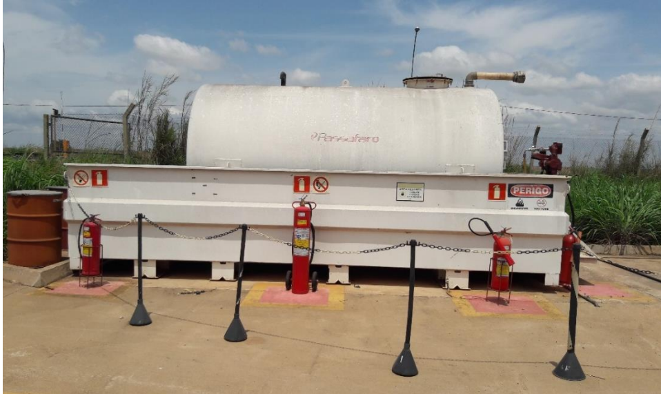
Figura 35 – Tanque de combustível
