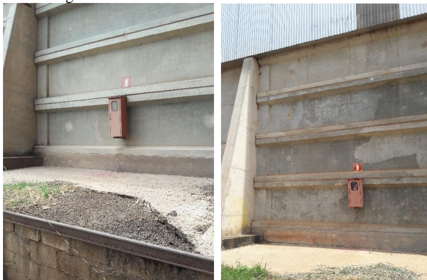
Figura 25 – Extintores no lado externo do armazém
