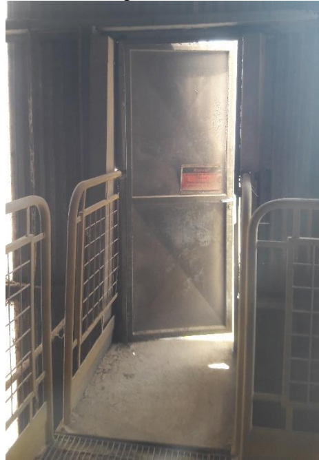
Figura 27 – Saída de emergência do armazém sem sinalização
