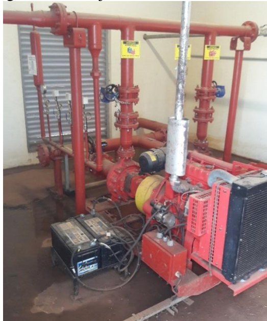
Figura 39 – Conjunto da bomba de incêndio
