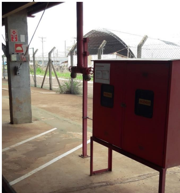
Figura 11 – Hidrante duplo e acionador da bomba de incêndio na classificação
