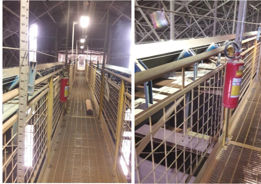
Figura 26 – Extintores na passarela do armazém
