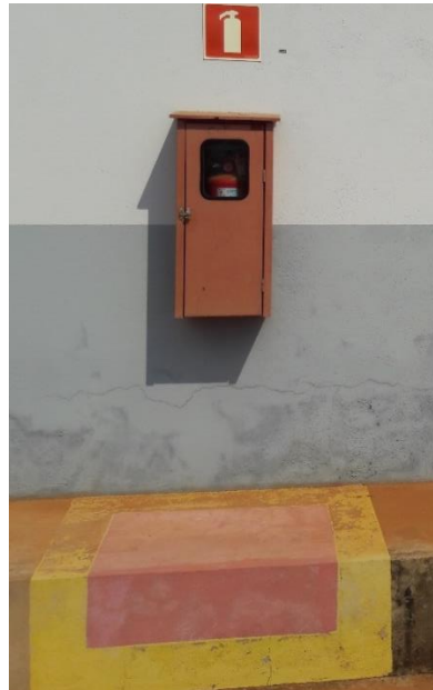
Figura 13 – Extintor do banheiro dos motoristas
