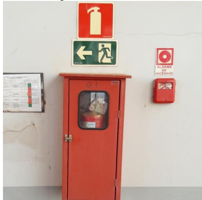
Figura 6 – Extintor do Gate
