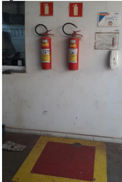
Figura 34 – Extintores da oficina
