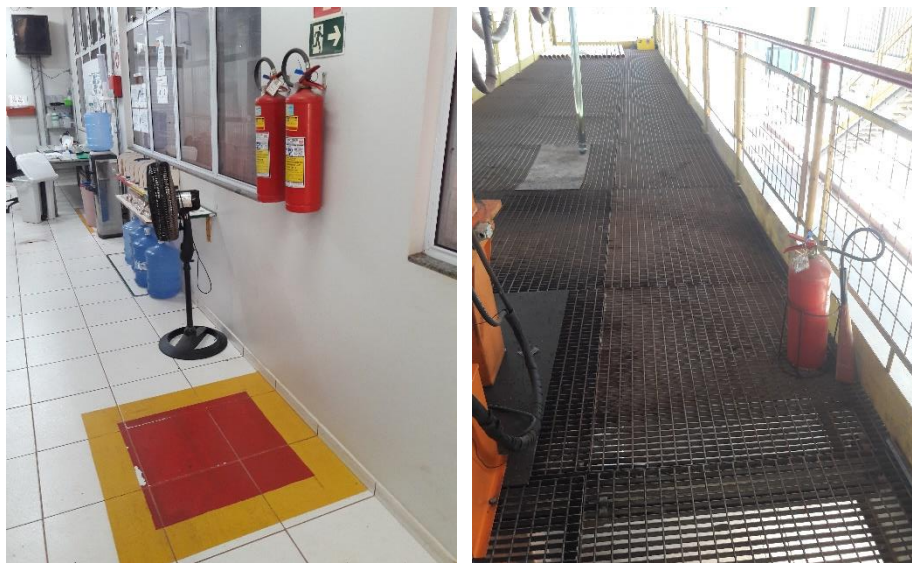
Figura 8 – Extintores distribuídos no piso superior da classificação
