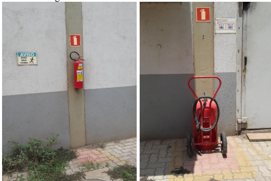
Figura 36 – Extintores do lado externo do CCM
