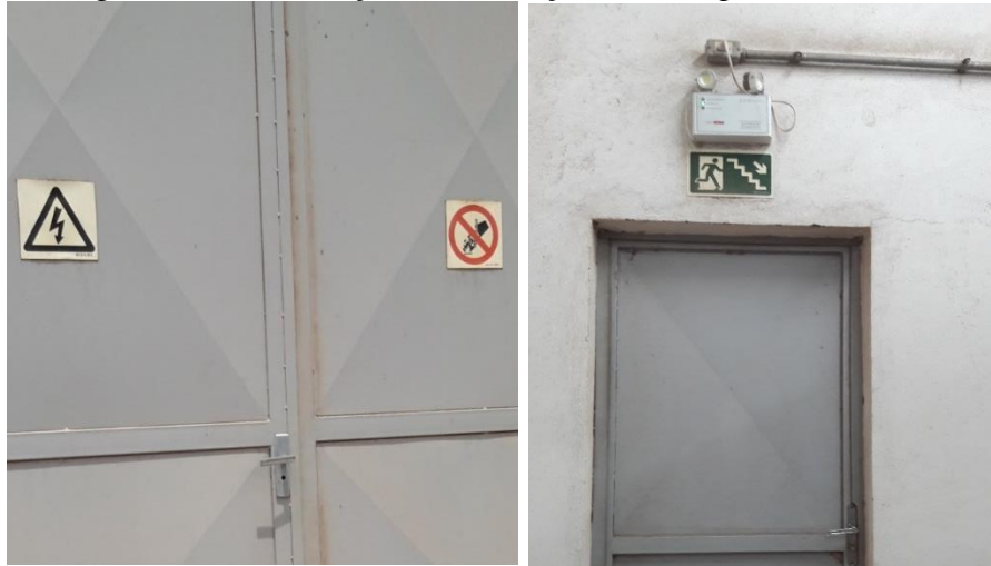
Figura 37 – Sinalização e iluminação de emergência no CCM
