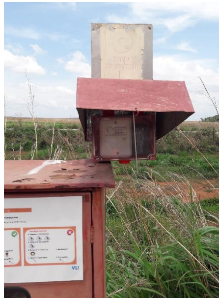
Figura 19 – Acionamento da bomba de incêndio
