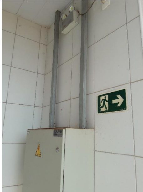
Figura 14 – Sinalizações e iluminação do banheiro dos motoristas
