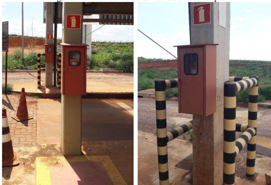
Figura 7 – Extintores do térreo da classificação
