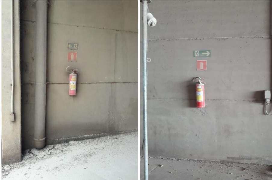
Figura 20 – Extintores do tombador sem pintura no piso
