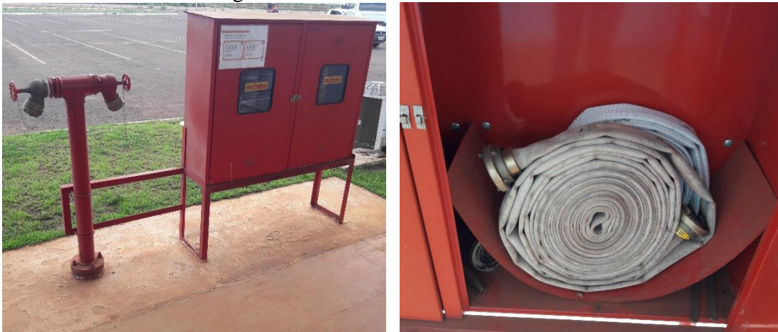
Figura 41 – Hidrante do administrativo
