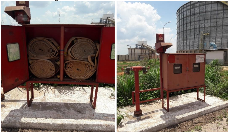
Figura 17 – Hidrante na saída do tombador
