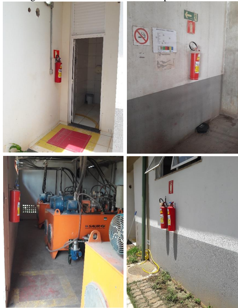
Figura 15 – Extintores distribuídos pelo tombador
