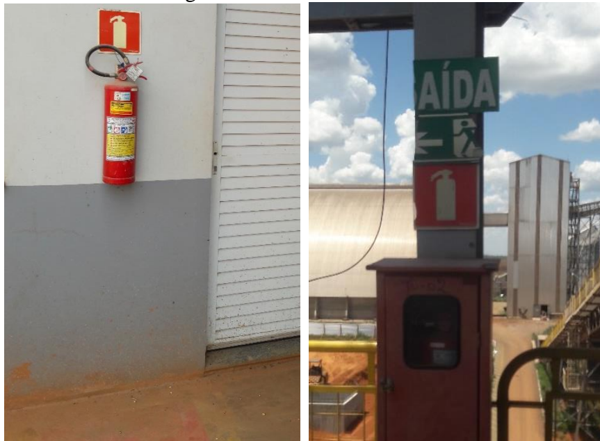
Figura 28 – Extintores da tulha
