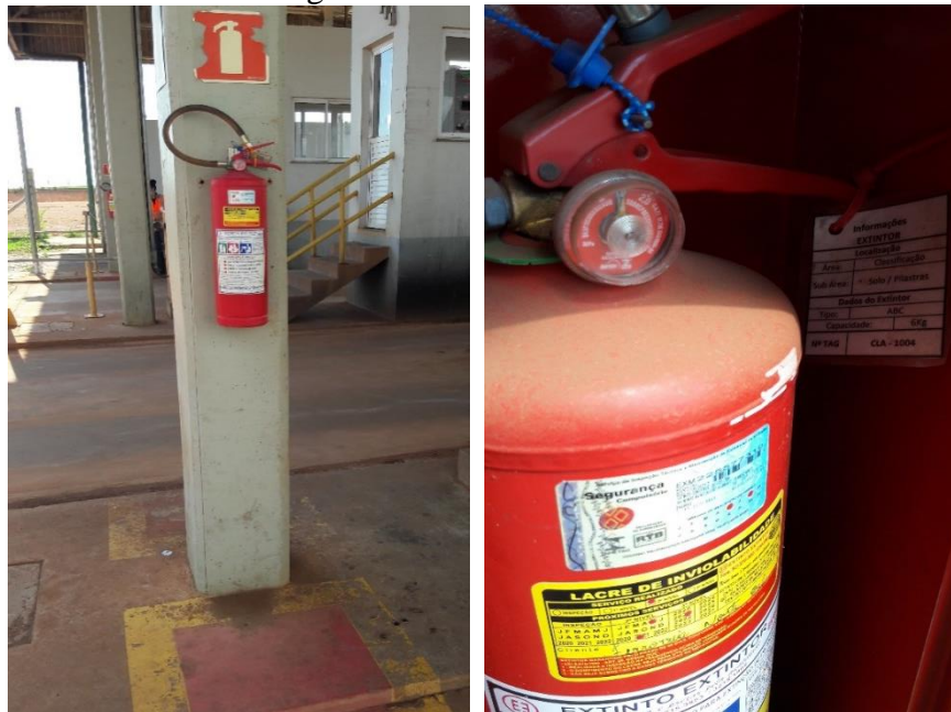
Figura 5 – Extintores do Gate
