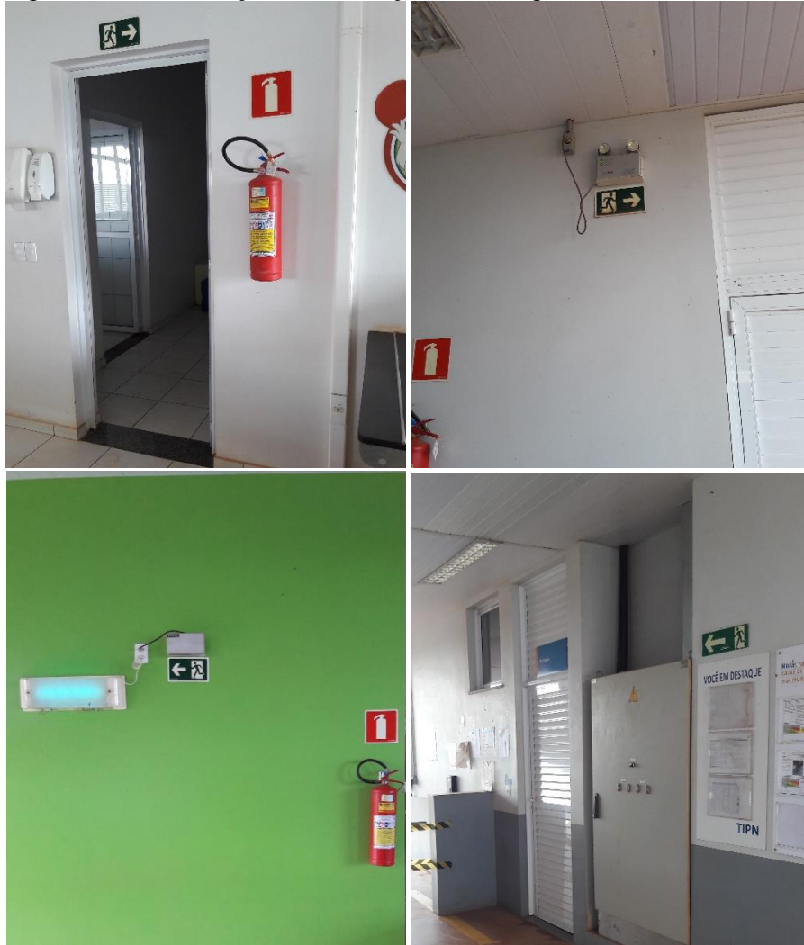
Figura 45 – Sinalização e iluminação de emergência no administrativo
