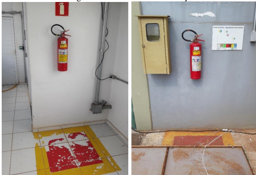
Figura 12 – Extintores da balança
