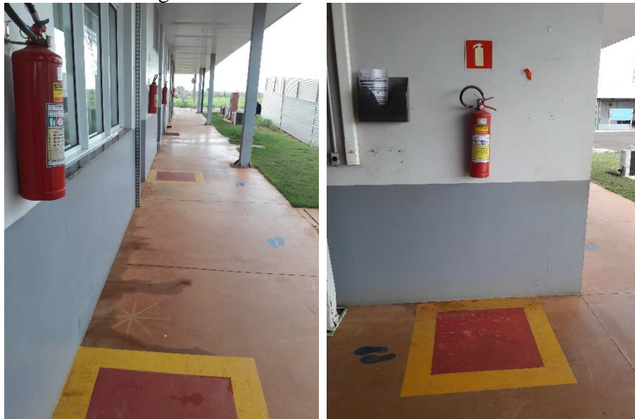
Figura 40 – Extintores do administrativo
