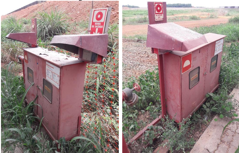
Figura 29 – Hidrantes da tulha
