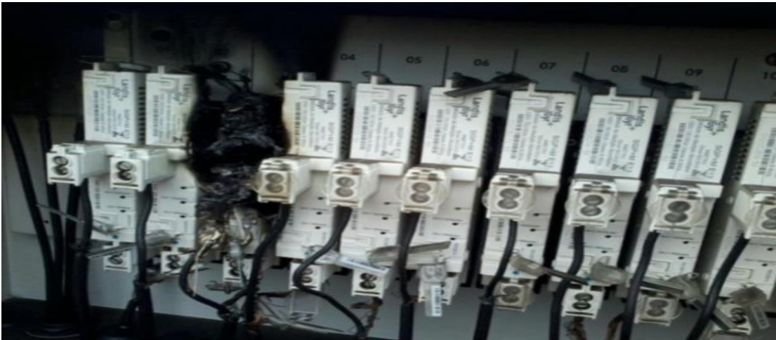
Figura 2 - Concentrador Secundário Landys com furto em medidor.
