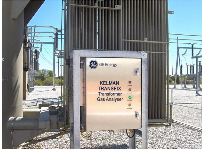
Figura 18 – Kelman Transfix instalado em transformador de força
