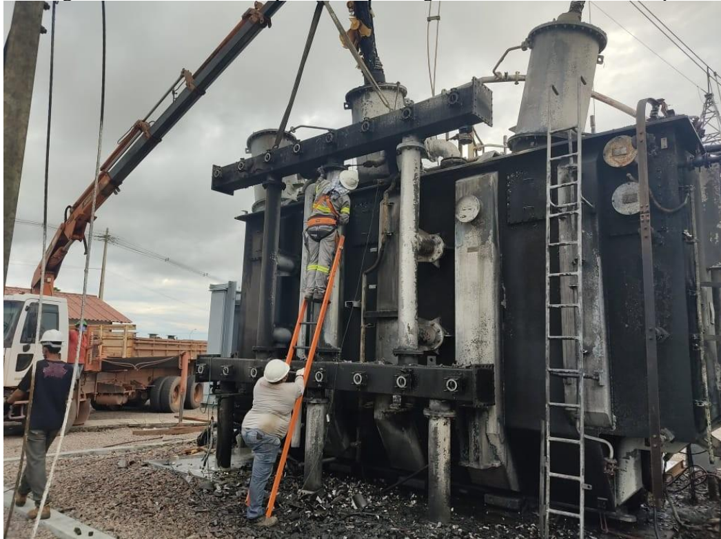
Figura 1- Transformador queimado que originou um blecaute no Amapá
