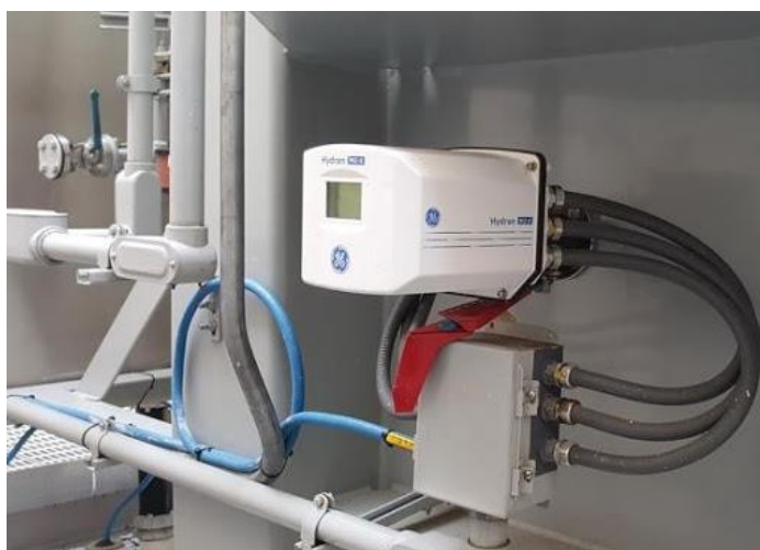
Figura 17 – Hydran instalado em transformador de força
