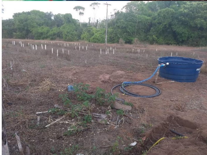
RFE 7 – Instalação da caixa de água de 2.000 L, para sucção do sistema de irrigação (período seco). Detalhe da MANGUEIRA PE 1.1/2\"/>
