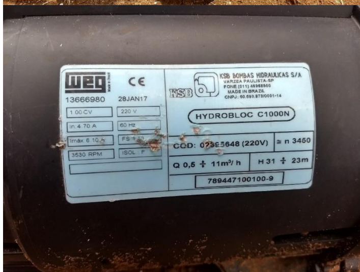
RFE 26 – Conjunto motobomba (KSB® Hydrobloc C1000N; Weg®; 1,0 CV; 220 V; 60 Hz; mínimo 4,70 A; máximo 6,10 A).
