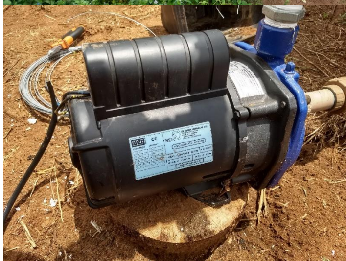
RFE 25 – Conjunto motobomba (KSB® Hydrobloc C1000N; Weg®; 1,0 CV; 220 V; 60 Hz; mínimo 4,70 A; máximo 6,10 A).
