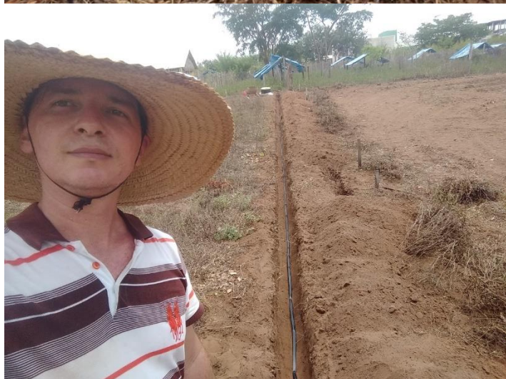
RFE 17 – Escavação manual a 0,30 m de profundidade, para posicionamento do tubo gotejador DRIPNET PC™ AS 16150.
