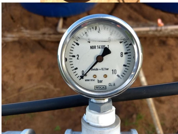
RFE 29 – Controle da pressão de trabalho através da regulagem do MANOMETRO 0 - 10 BAR C/ GLICERINA.
