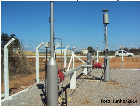
Foto 03: Queimadores de gás metano.
