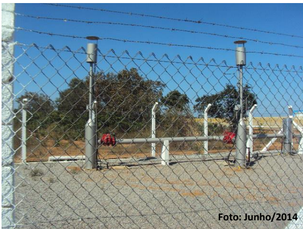
Foto 05: Vista frontal dos queimadores de gás metano.
