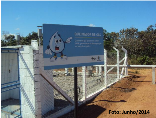
Foto 01: Local do sistema de queimadores de gás.
