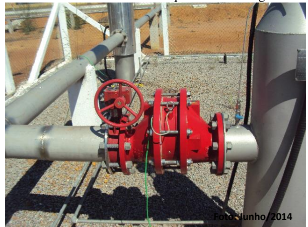
Foto 04: Registro de segurança do sistema de queimadores.
