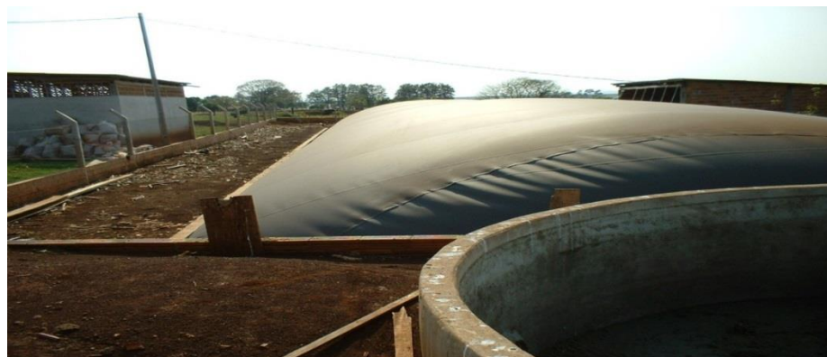
Figura 8 - Biodigestor tubular com capacidade de 800 m 3 .
