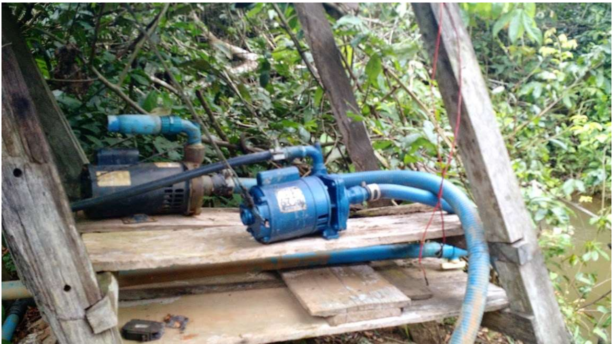
Figura 32. Imagem do conjunto de bombas de sucção utilizadas para captar água no Ribeirão Água Fria.
