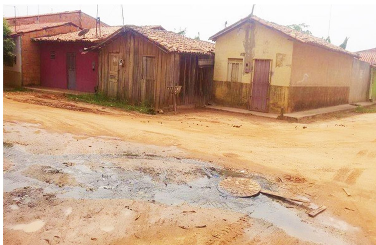
FIGURA 32: Vazamento de esgoto no cruzamento entre as Ruas Das Sombras e Nossa Senhora Aparecida no bairro Santa Inês, Imperatriz/MA - 2015. Fonte: pesquisa de campo. Foto: elaboração própria.
