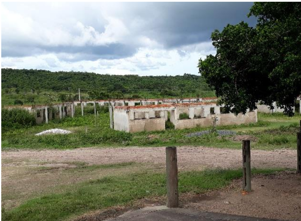
Figura 8 - Construção inacabada onde seria instalada a Escola para atender a modalidade Ensino Médio no Projeto de Assentamento Manoel Alves no município de Araguaína-TO.
