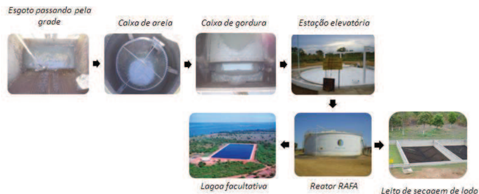
Figura 1. Componentes da ETE localizada na Vila União, Palmas-TO, Brasil. O esgoto bruto passa através da grade e os sólidos grosseiros são retidos. As quantidades de areia e gordura são retidas nas caixas de areia e gordura, respectivamente. A estação elevatória conduz o esgoto pré-tratado para o tratamento biológico no reator RAFA. O efluente do reator RAFA vai para a lagoa facultativa onde os nutrientes e a matéria orgânica particulada serão removidos, permitindo o desenvolvimento de várias espécies. O lodo anaeróbico formado no reator RAFA é disposto no leito de secagem e transportado para valas e aterro.
