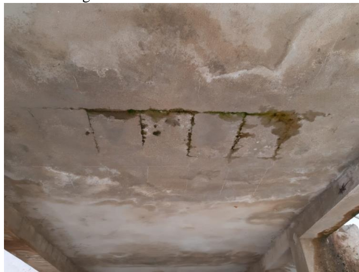
Figura 26 – Corrosão das armaduras
