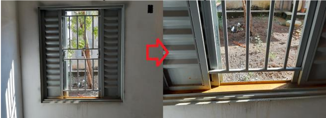
Figura 27 – Corrosão das esquadrias
