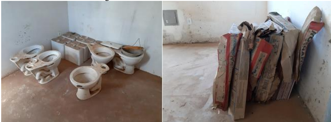
Figura 33 – Material mal acomodado
