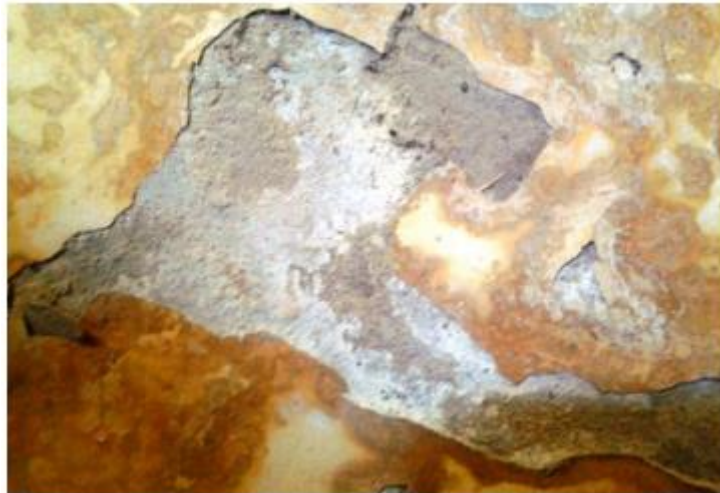
Figura 11 - Degradação da alvenaria por causa da eflorescência
