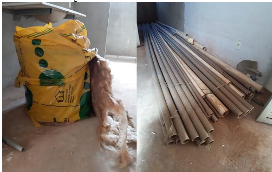
Figura 34 – Material mal acomodado
