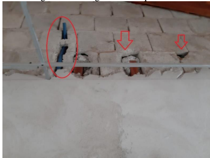
Figura 29 – Rasgo e blocos quebrados
