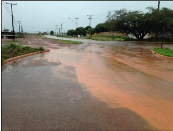
Figura 9. Falta de meio-fio originando assoreamento na via de acesso a rotatória
