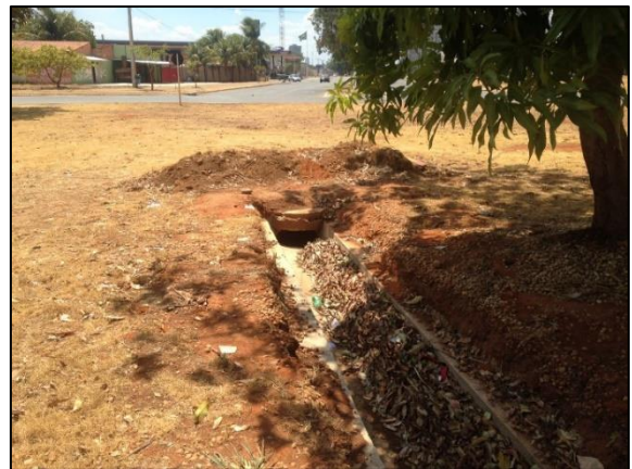
Figura 8. Dispositivo de drenagem sem limpeza
