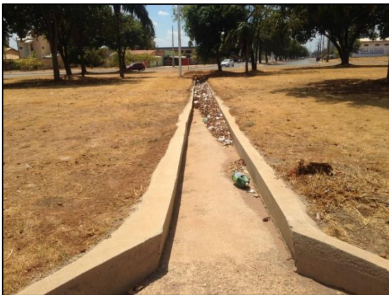
Figura 7. Dispositivo de drenagem sem limpeza
