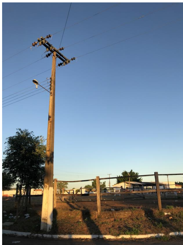
Figura 55 - Fiação aérea de energia elétrica
