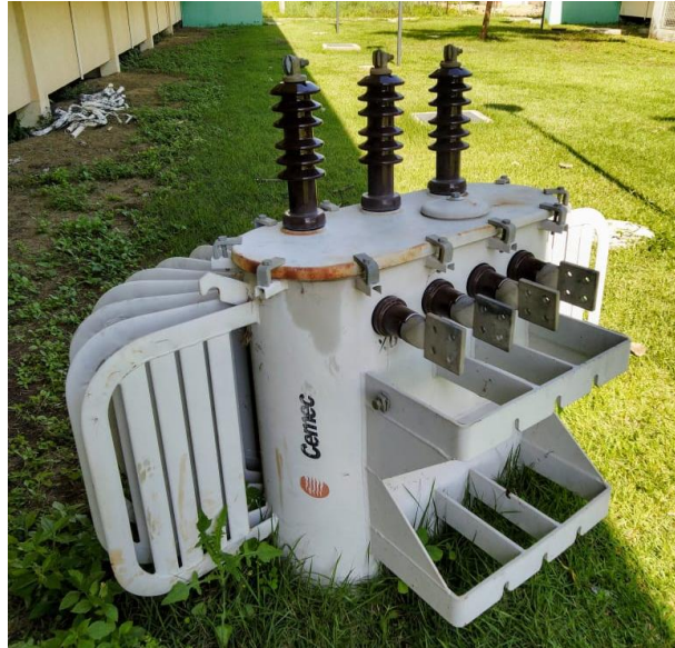
Figura 27 - Transformador trifásico de 225 kVA
