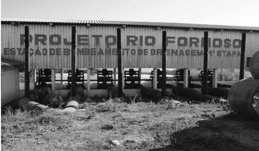
Figura 26 – Estação de bombeamento para o Projeto Rio Formoso
