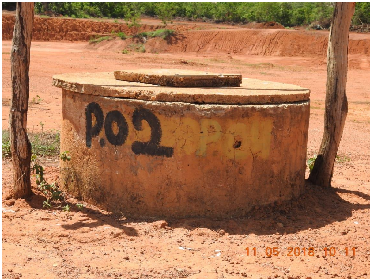
Figura 6.10: Poço de monitoramento do lençol freático instalado na área do Aterro Sanitário de Palmas - TO.
