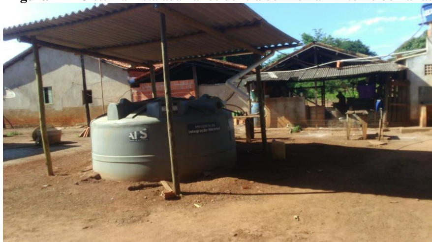
Figura 17 - Cisterna instalada na residência de Diomar Antonio de Farias
